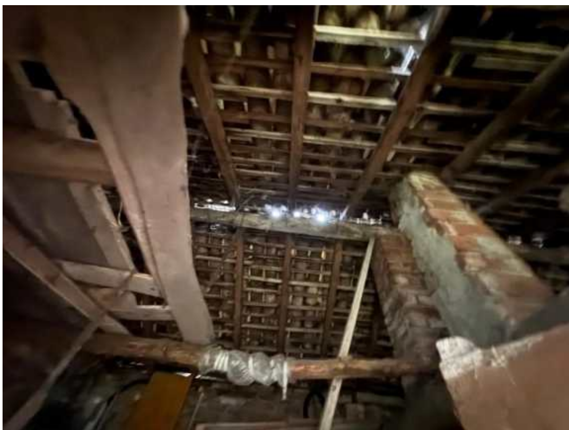
Particolare copertura fatiscente del deposito
