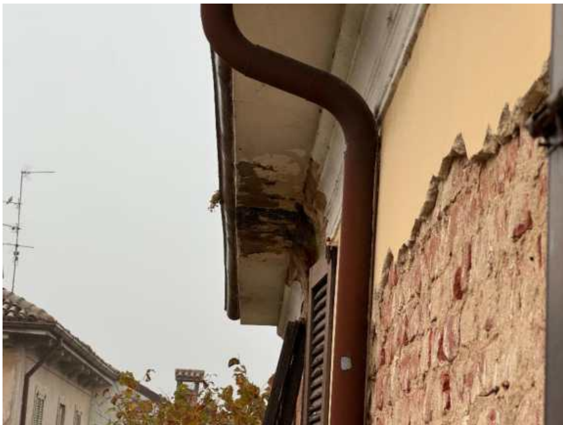
Particolare ammaloramento canale di gronda
