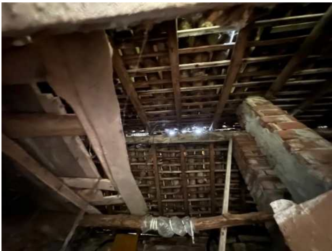
Particolare copertura fatiscente del deposito
