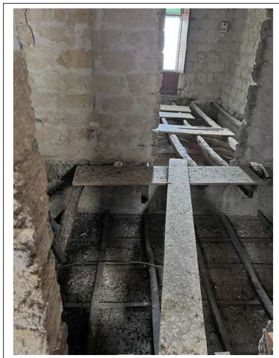
Foto n. 38-39. Immobile identificato al sub. 14 in cui è crollato il solaio di calpestio
