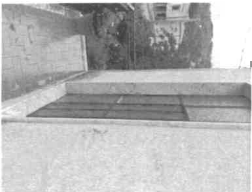
Fot. 16 – Pavimento divelto balcone e infisso vano scala
