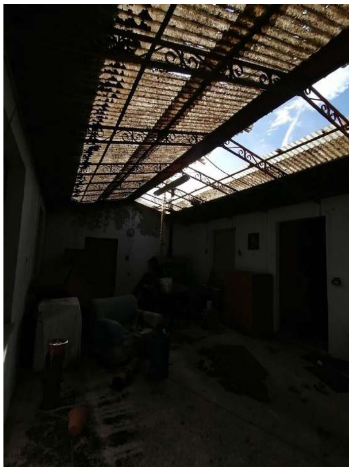
16 Veranda ammalorata (piano primo) a protezione del terrazzo fra mapp.134 sub 12 e sub 15 (parte comune sub 16);
