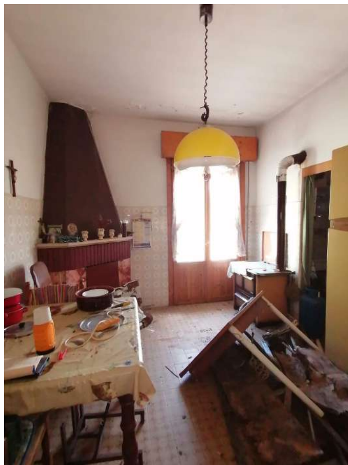
20 Scorcio vano pranzo (mapp.134 sub15) con portafinestra aperta sul solaio piano ( terrazzo privo di protezioni );
