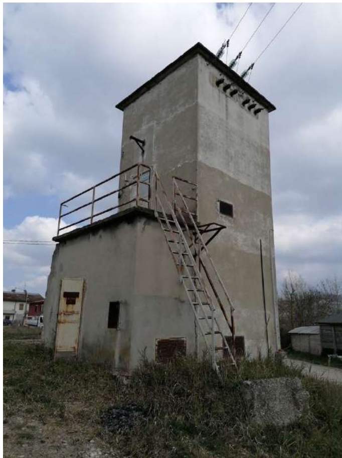
9 Cabina Enel storica destinata all'opificio mapp 134 sub 17 ( fatiscante e degradata );
