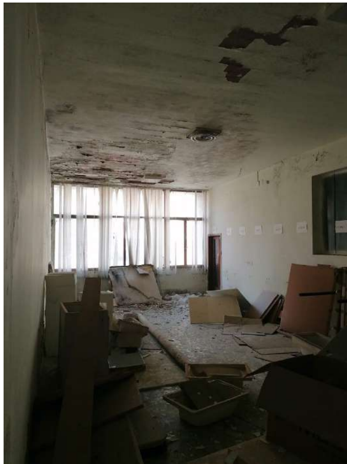
13 Vista magazzino piano terra mapp.134 sub12 (sono visibili infiltrazioni da solaio superiore coperto da veranda ammalorata);
