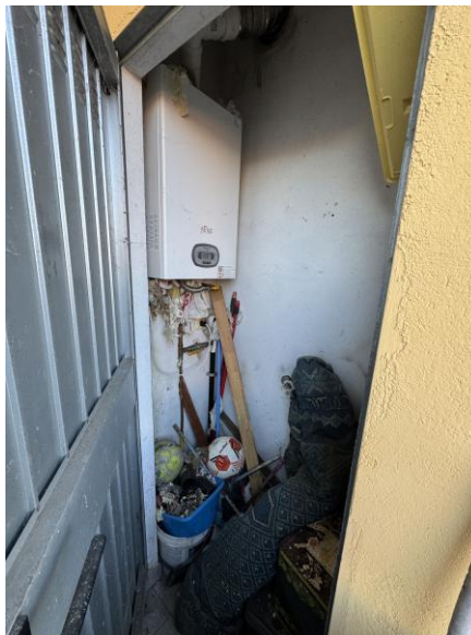
Vista centrale termica e caldaia murale
