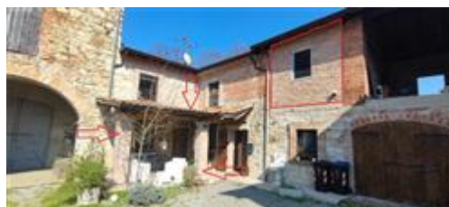
difformità prospetti esterni
