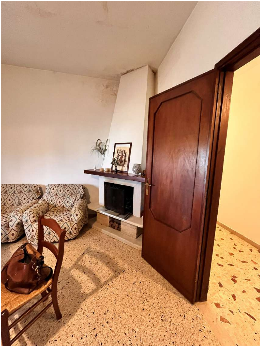
Foto 10 – Vista sul soggiorno con particolare del camino a legna. Si notano inoltre dei danni sul soffitto dovuti ad infiltrazione di acqua
