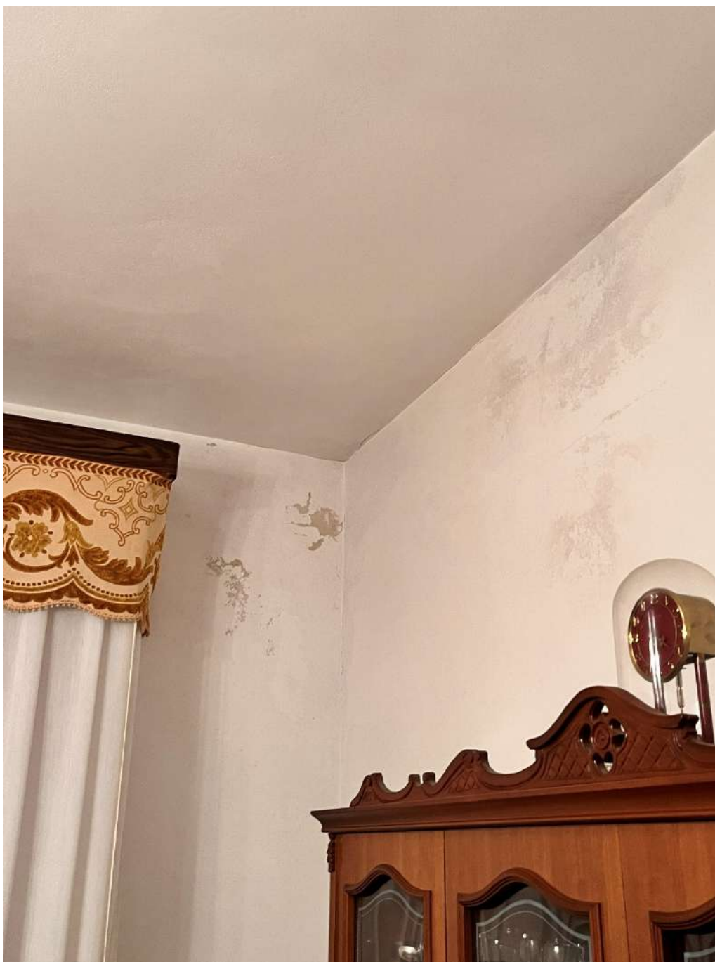
Foto 5 – Particolare con segni di infiltrazione di acqua nella sala da pranzo.
