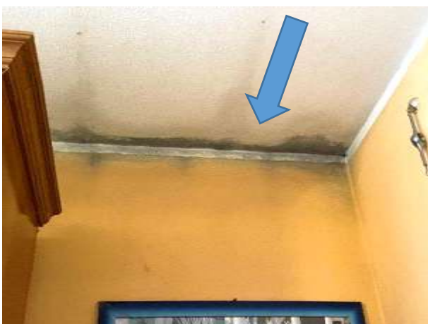
foto della muffa presente nella parete della camera da letto e nel soffitto
