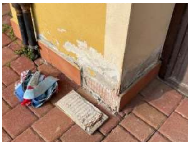
Dettaglio del muro perimetrale del fabbricato che presenta fenomeni di risalita umidità
