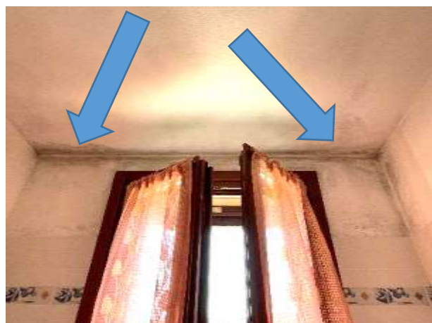
foto della muffa presente nella parete del bagno e nel soffitto
