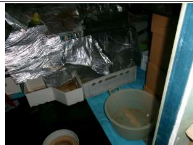
Dettaglio perdite dalla copertura
