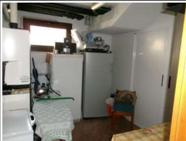
Ripostiglio (ad uso centrale termica) - 1°P sottostrada
