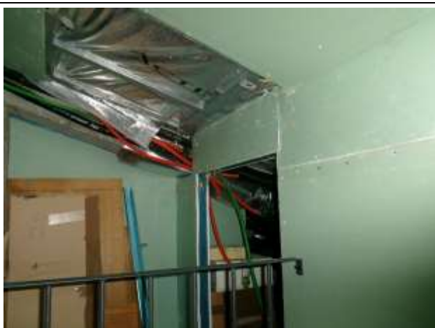
Dettaglio perdite dalla copertura
