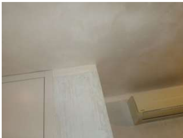
Dettaglio infiltrazioni dal sottotetto nella camera da letto – 1°P
