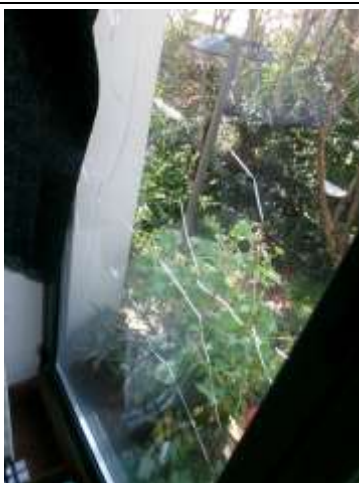
Dettaglio vetro rotto in veranda – Piano rialzato
