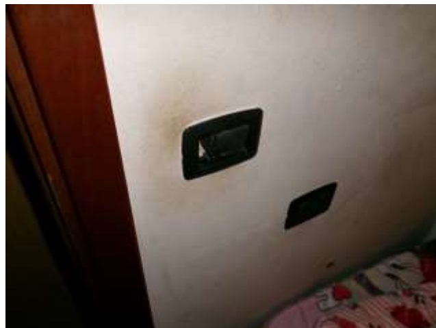
Dettaglio criticità sui frutti dell'impianto elettrico
