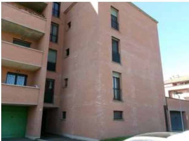
Dettaglio segni di umidità nella facciata
