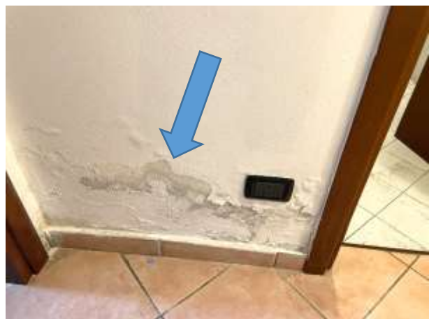
foto de segni di umidità nelle pareti
