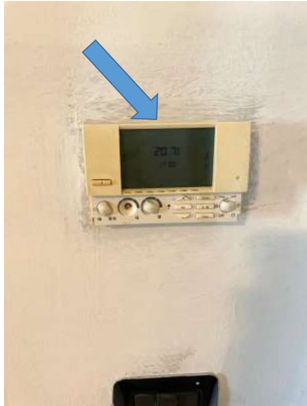
foto del cronotermostato danneggiato ma funzionante
