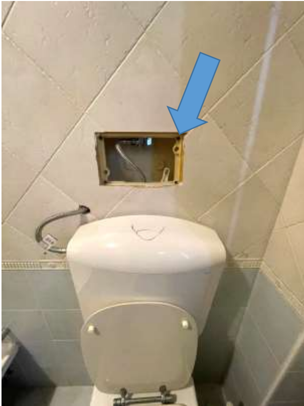
foto della cassetta di scarico del water danneggiata
