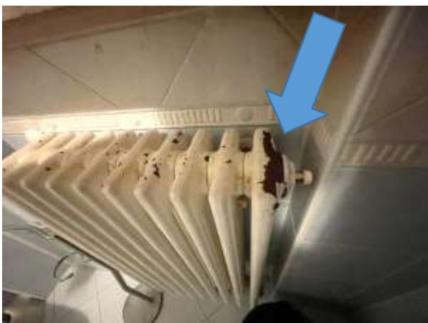
foto di un termosifone arrugginito
