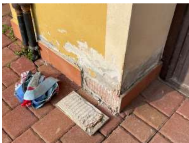
Dettaglio del muro perimetrale del fabbricato che presenta fenomeni di risalita umidità
