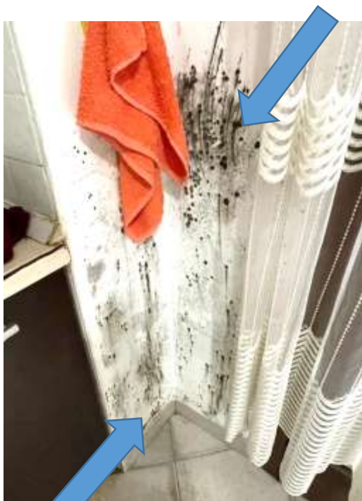
foto della muffa presente nella parete del soggiorno
