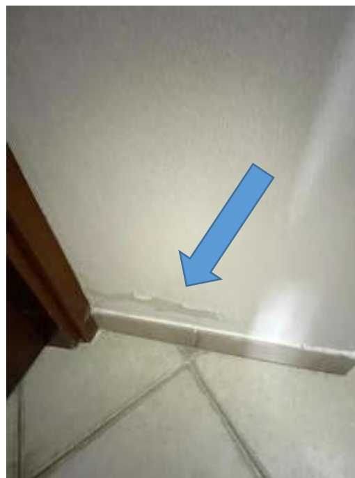
foto dell'umidità nelle pareti
