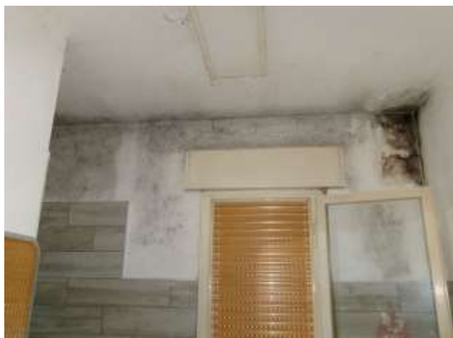
Dettaglio infiltrazioni nel bagno - 1°P
