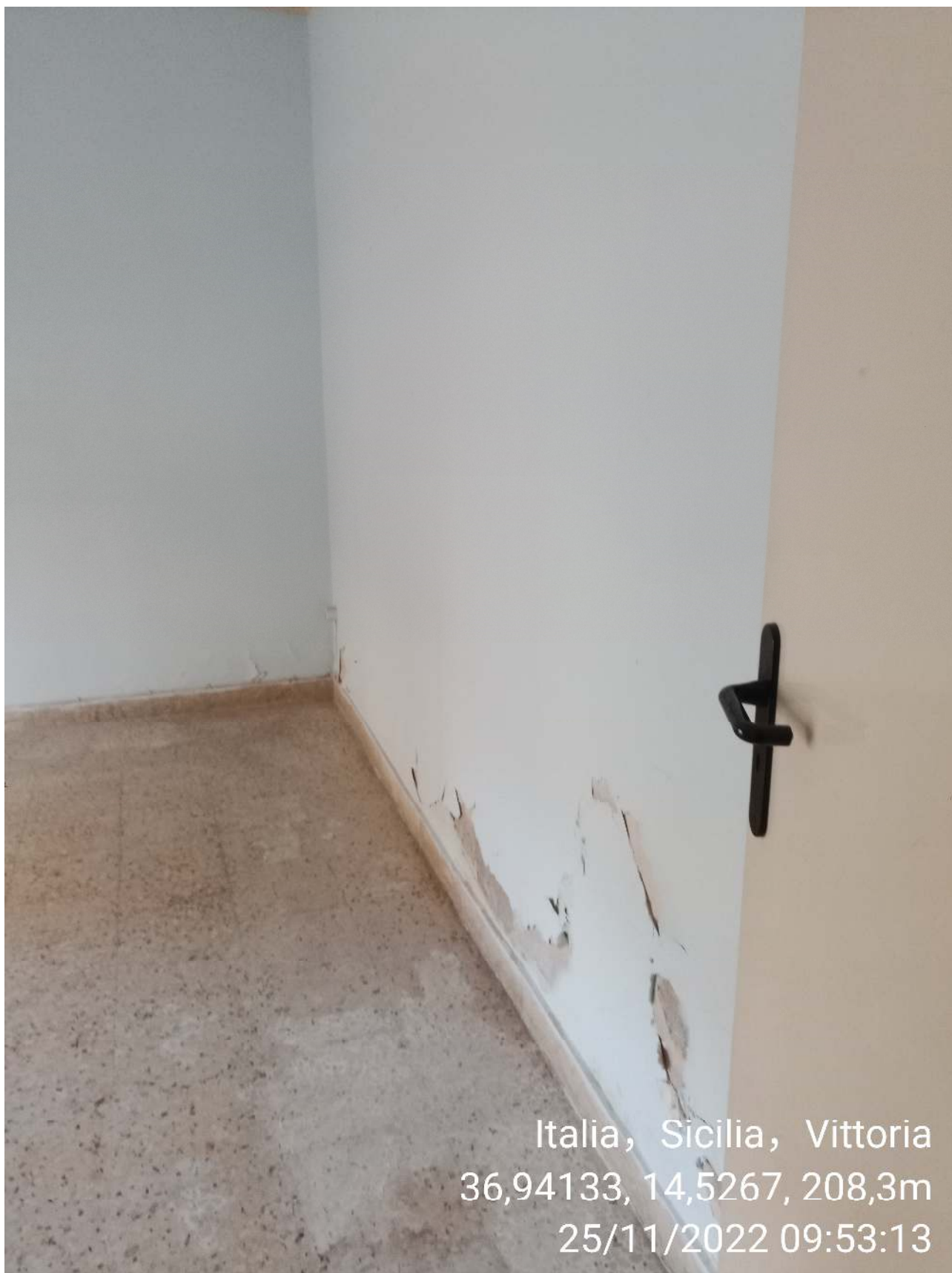
Figura 7 – Degrado risalita capillare camere da letto
