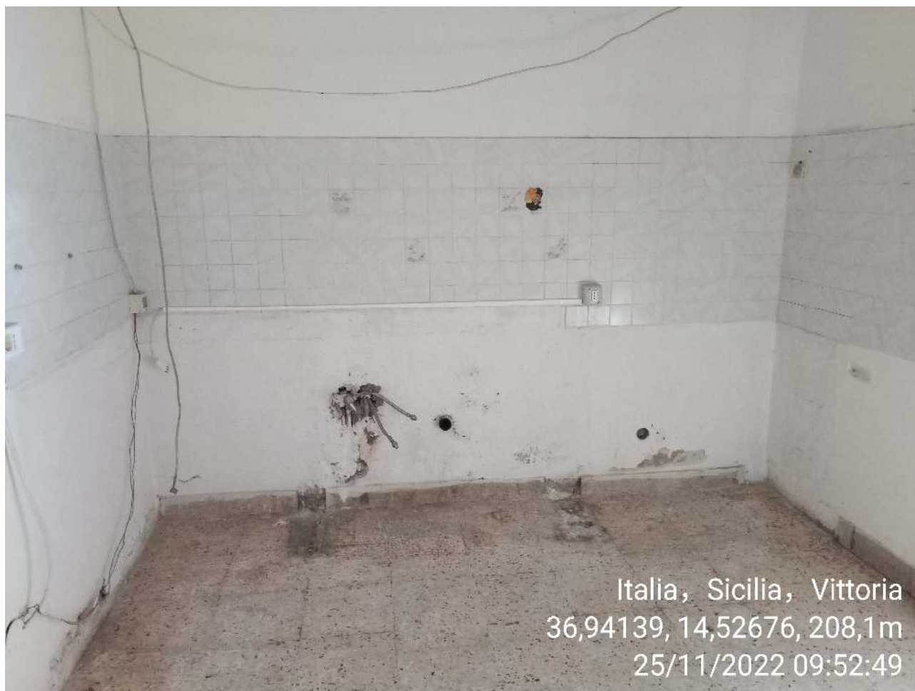
Figura 5 – degrado da usura nella cucina
