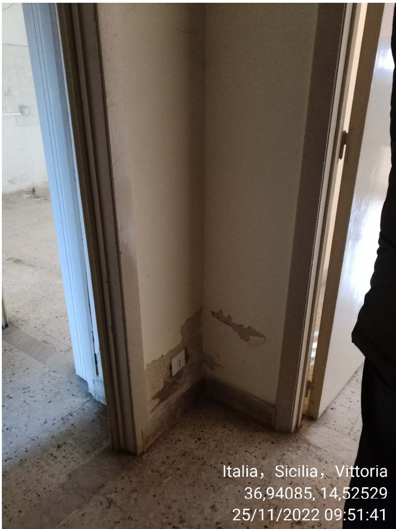
Figura 4 - degrado da risalita capillare nel corridoio
