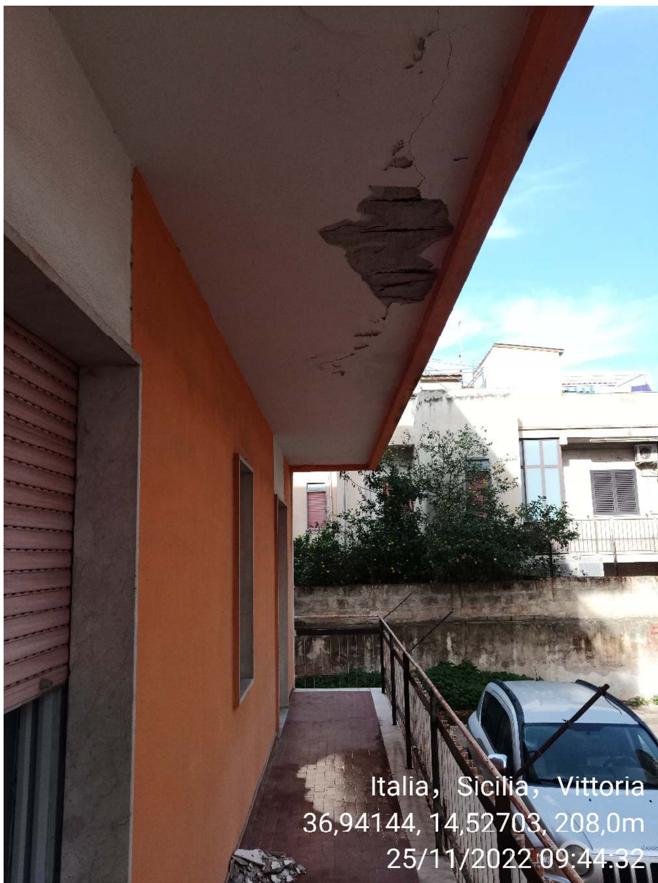
Figura 1 – Individuazione del degrado esterno (distacco del copriferro a seguito di ossidazione delle armature)
