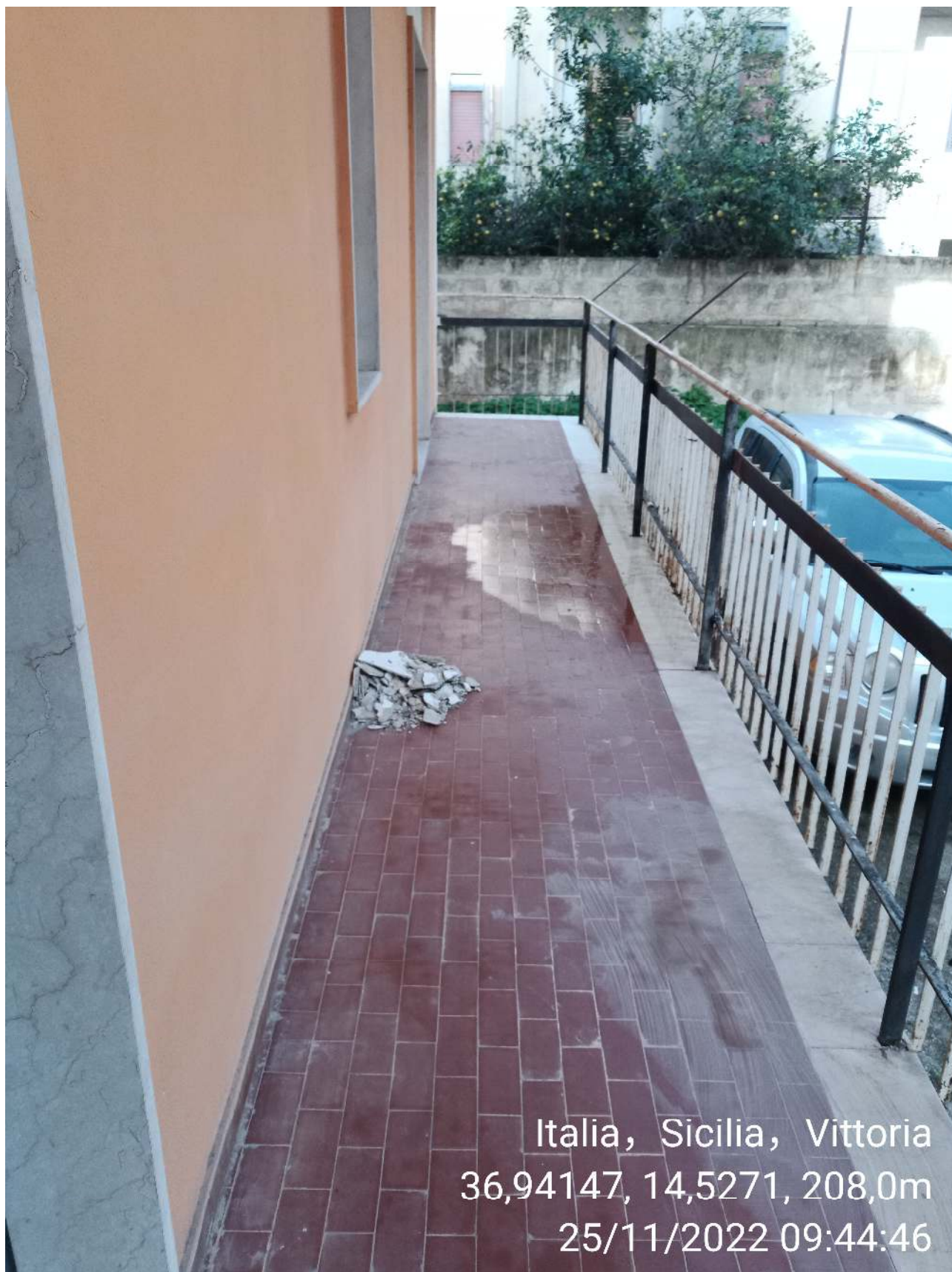
Fig. 2 - individuazione delle parti di intonaco già distaccate
