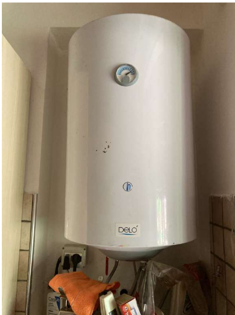
12 Boiler cucina PT.jpeg
