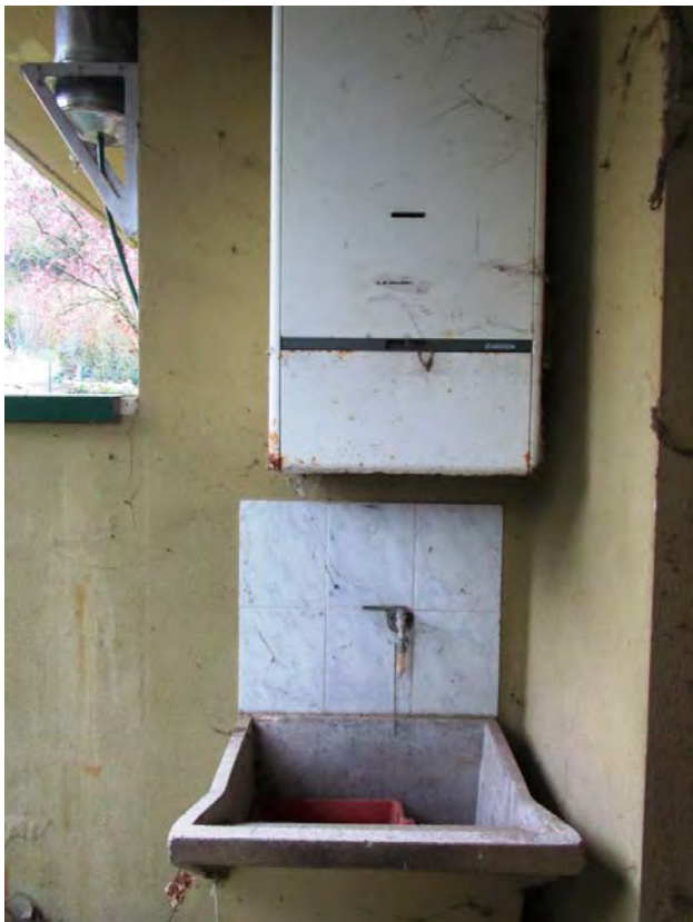
Terrazzo Caldaia M
