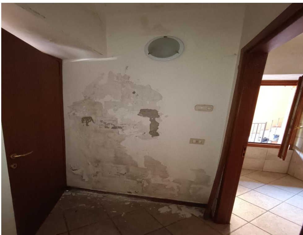
SEGNII DI INFILTRAZIONE DISIMPEGNO
