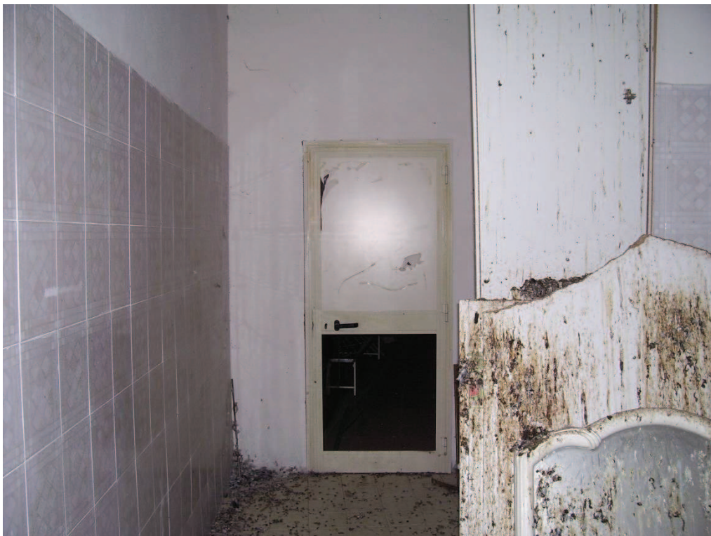
Foto 18 Porta di collegamento del sub 3 col sub 47
