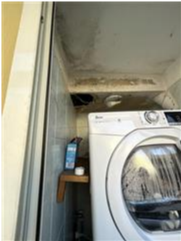
nicchia lavanderia con segni di umidità
