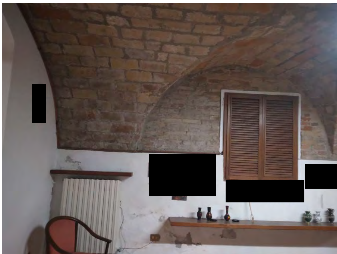
Foto n. 10 – uno scorcio del grande vano centrale posto nel seminterrato, ben visibili le volte di laterizio in foglio e le vaste zone ammalorate a causa dell'umidità di risalita e contro-terra
