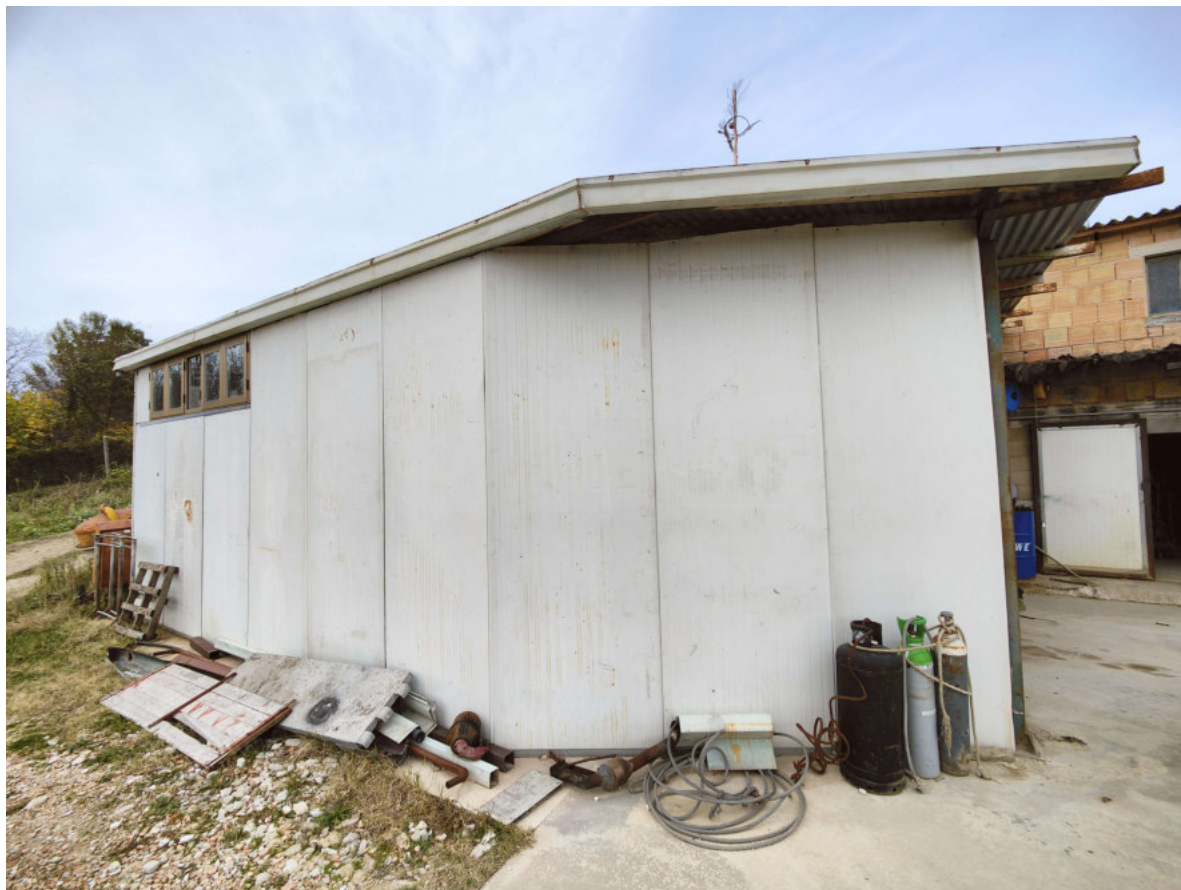
11) Struttura precaria (3) da rimuovere
