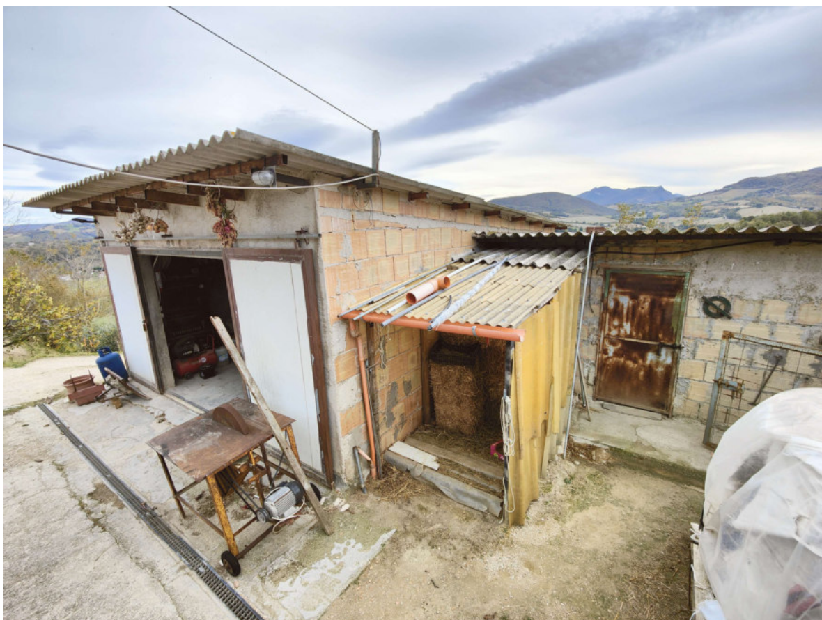
08) Struttura precaria (1) da rimuovere
