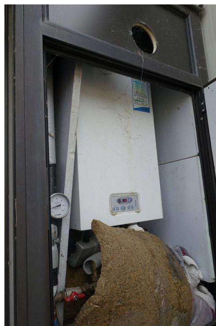
Fig. 25 – La caldaia a gas
