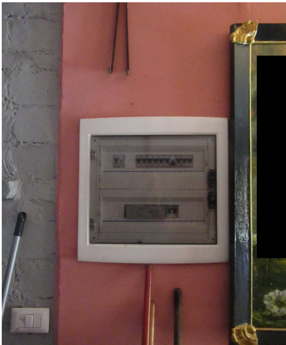
Foto 21: Quadro elettrico in garage
