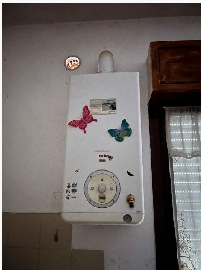
FOTO 4 _ VISTA INTERNA –DETTAGLIO CALDAIA APPARTAMENTO SUB 6 – PIANO SECONDO
