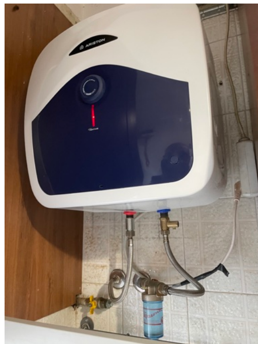
foto boiler elettrico.jpg 25 febbraio 2026 alle ore 09:38:47
