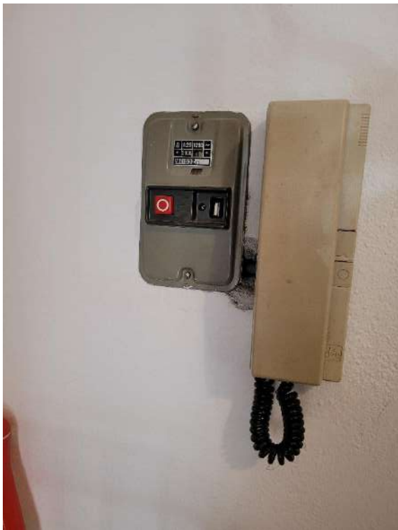
Foto 11- "Quadro" elettrico interno
