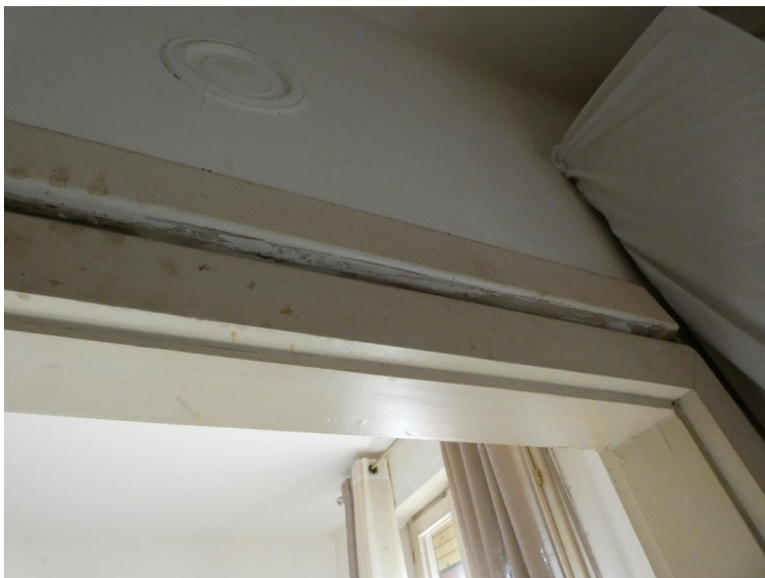
Presafotografica 53 – Vista Interna: Dettaglio distacco della cornice della porta nel Cucinotto
