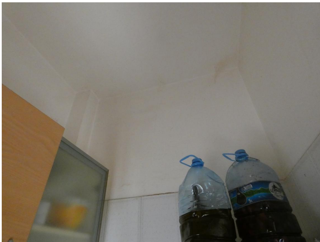
Presa fotografica 24 – Vista Interna: Cucinotto e dettaglio ammaloramenti murari
