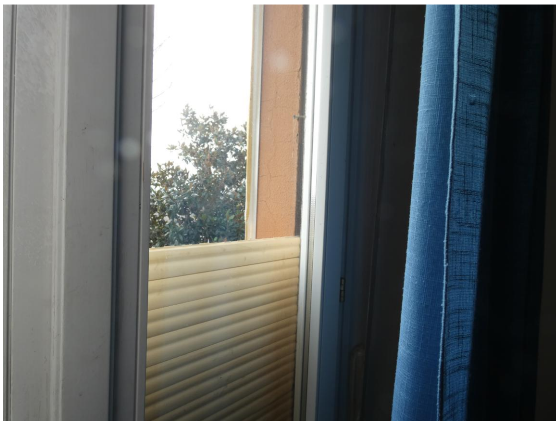
Presenza fotografica 43 – Vista Interna: Camera Letto 1, dettaglio tapparella rotta della porta finestra che porta al secondo balcone
