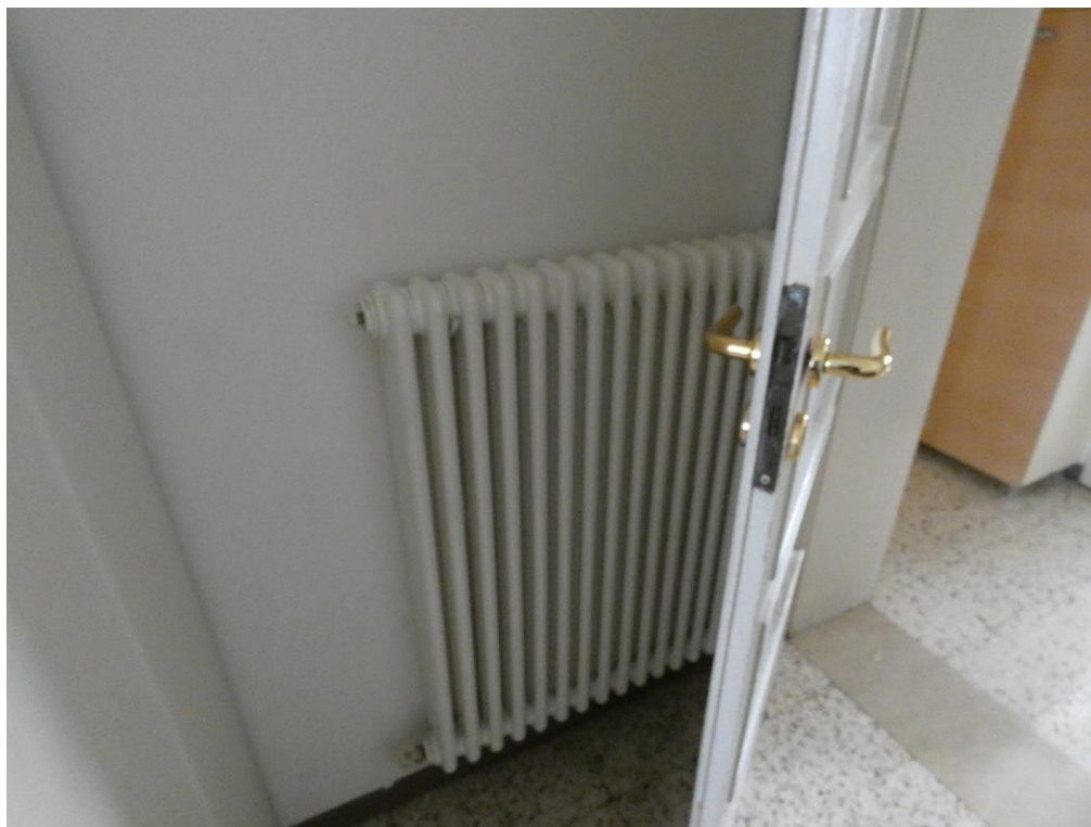
Presa fotografica 52 – Vista Interna: Camera Letto 2, dettaglio radiatore
