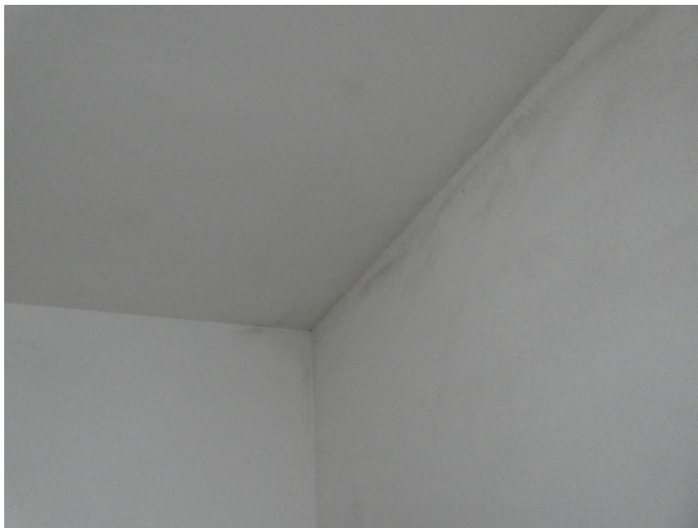
Presafotografica 50 – Vista Interna: Camera Letto 2, dettaglio ammaloramenti pareti perimetrali
