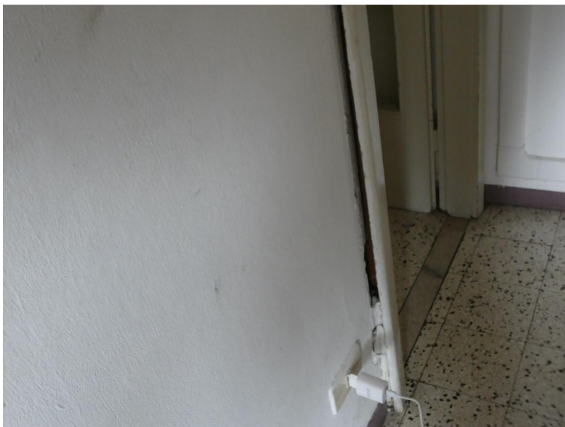
Presa fotografica 55 – Vista Interna: Dettaglio distacco della cornice della porta nel Soggiorno
