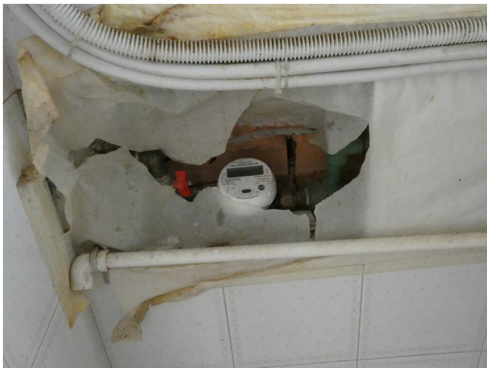
Presafotografica 54 – Vista Interna: Dettaglio contatore acquedotto all'interno del Cucinotto, senza protezione
