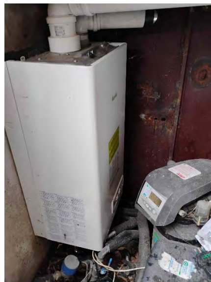
Dettaglio caldaia – p.t.
