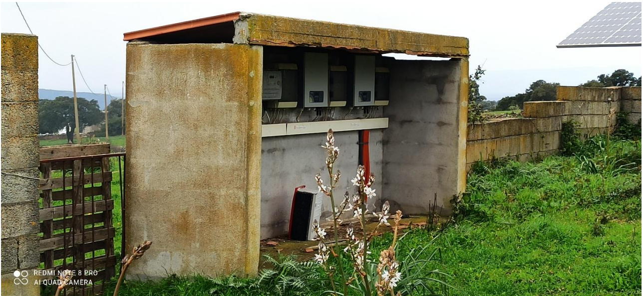
Foto n. 5 – vista locale tecnico impianto fotovoltaico
