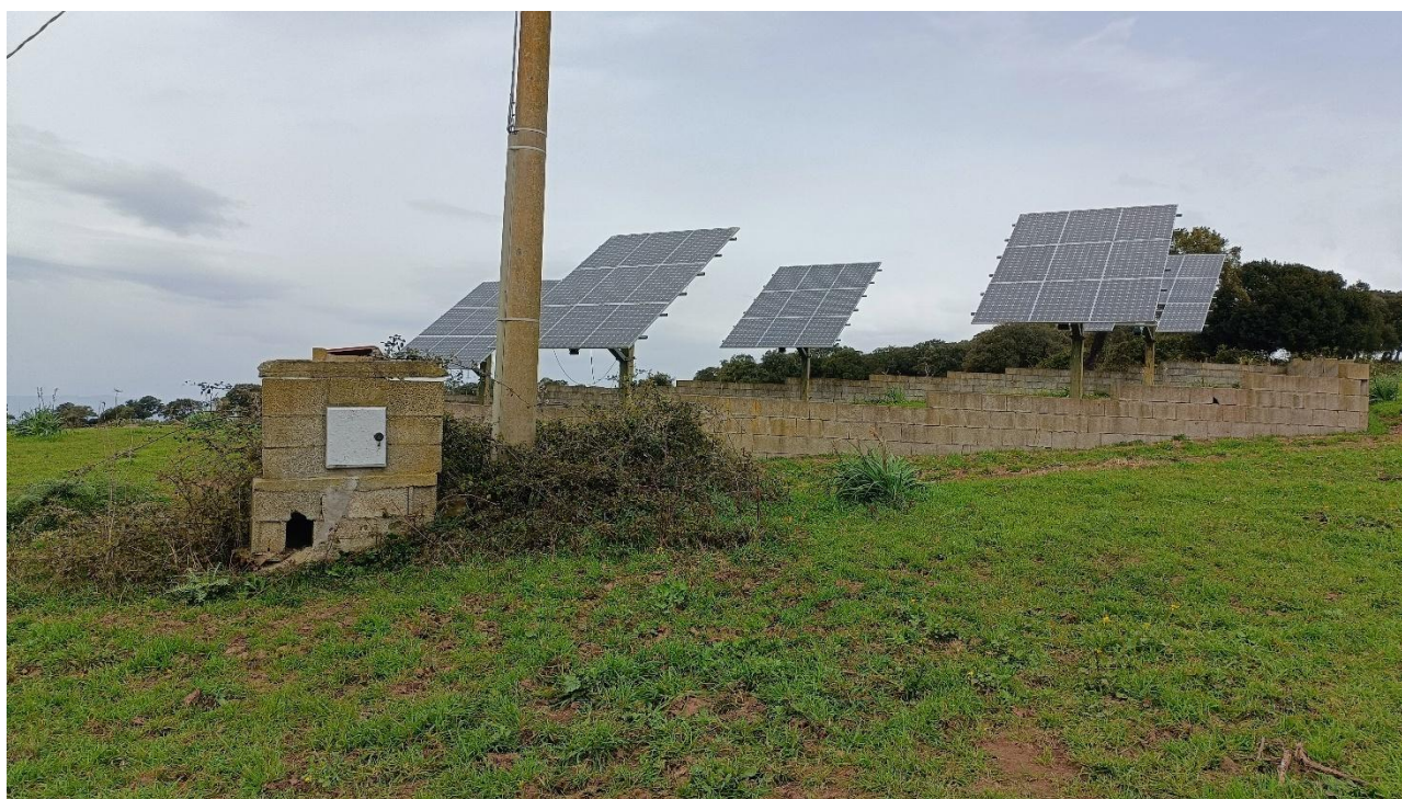
Foto n. 4 – vista impianto fotovoltaico
