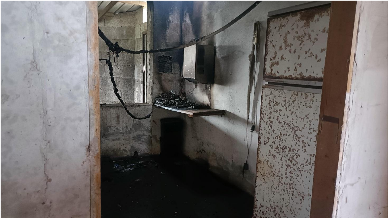
Foto n. 7 – vista interna, ripostiglio con QE
