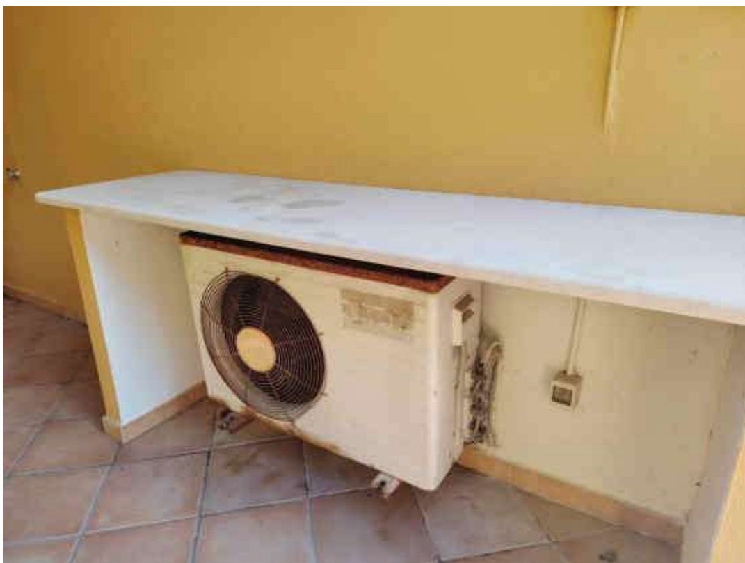
Foto 11 – Unità climatizzatore sotto veranda coperta
