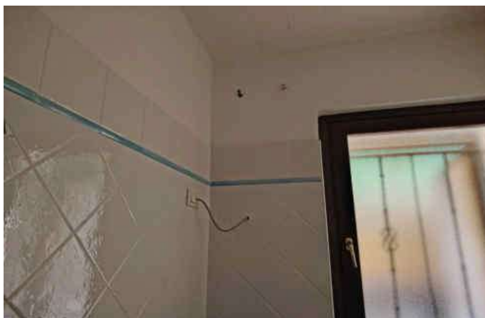
Foto 26 – Dettaglio comando accensione interno per Boiler ACS esterno
