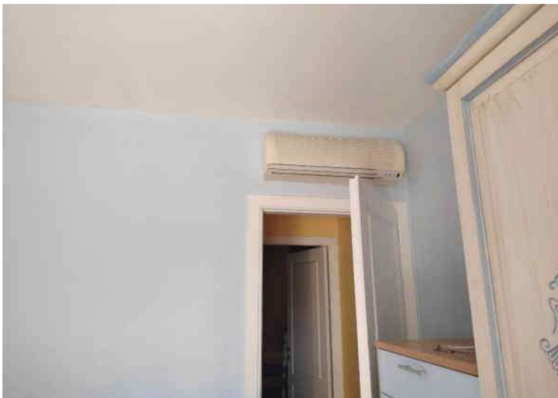
Foto 21 – Unità climatizzazione interna camera da letto principale
