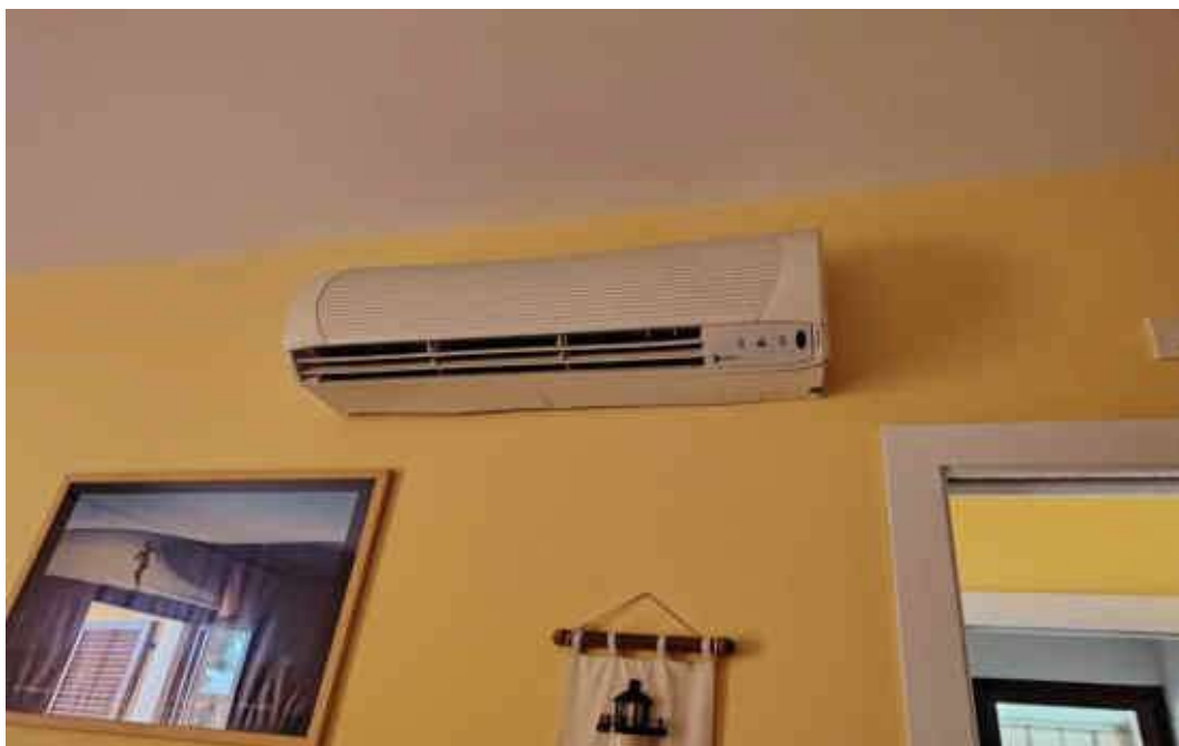
Foto 17 – Dettaglio unità interna climatizzazione soggiorno - cucina
