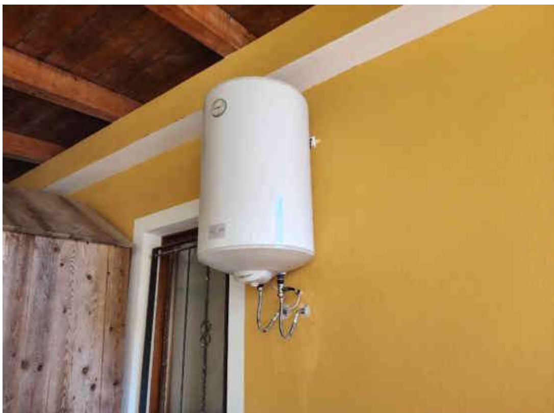
Foto 12 – Unità boiler ACS sotto veranda coperta
