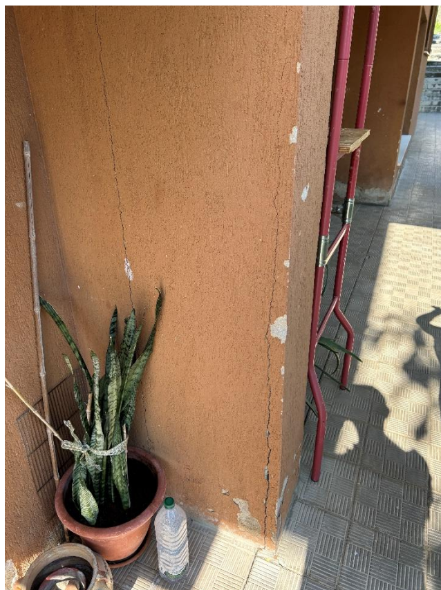
FOTO 14 – DETTAGLIO LESIONI INTONACO SU MURATURE ESTERNE
