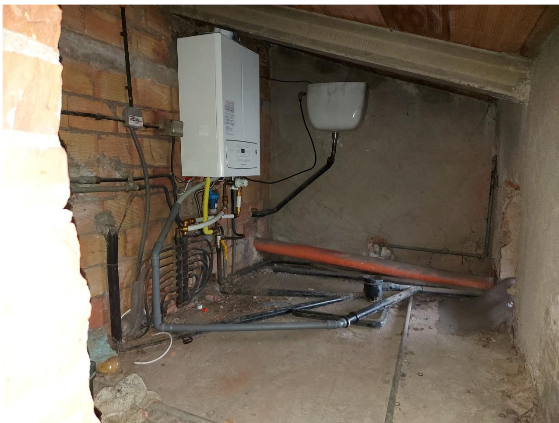
Foto 101: Piano secondo – Soffitta 3 - caldaia
