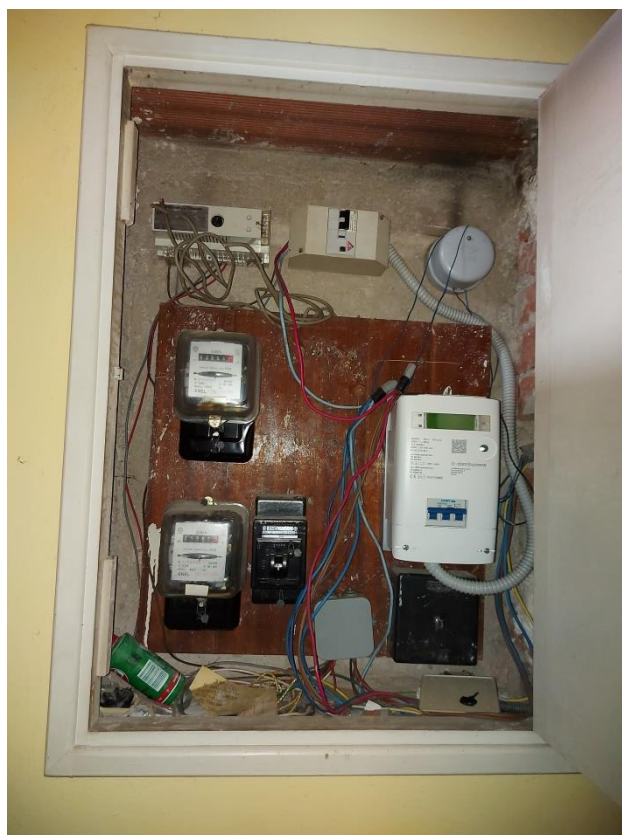
Foto 27: Vano scale di piano terra – contatori
