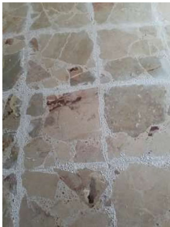
Foto n. 11 – Fenomeni di risalita nel pavimento
