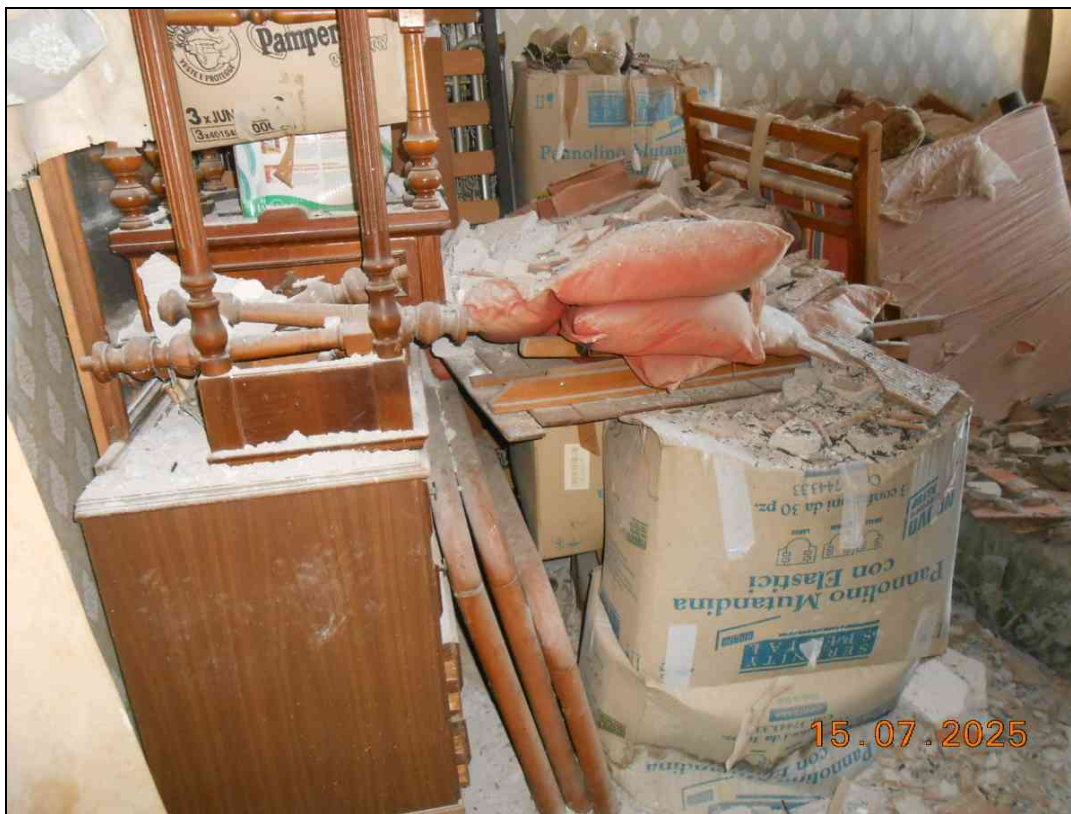
FOTO N. 29 Vista interna piano primo dell'immobile. Si notano arredi devastati e calcinacci crollati dal soffitto.
