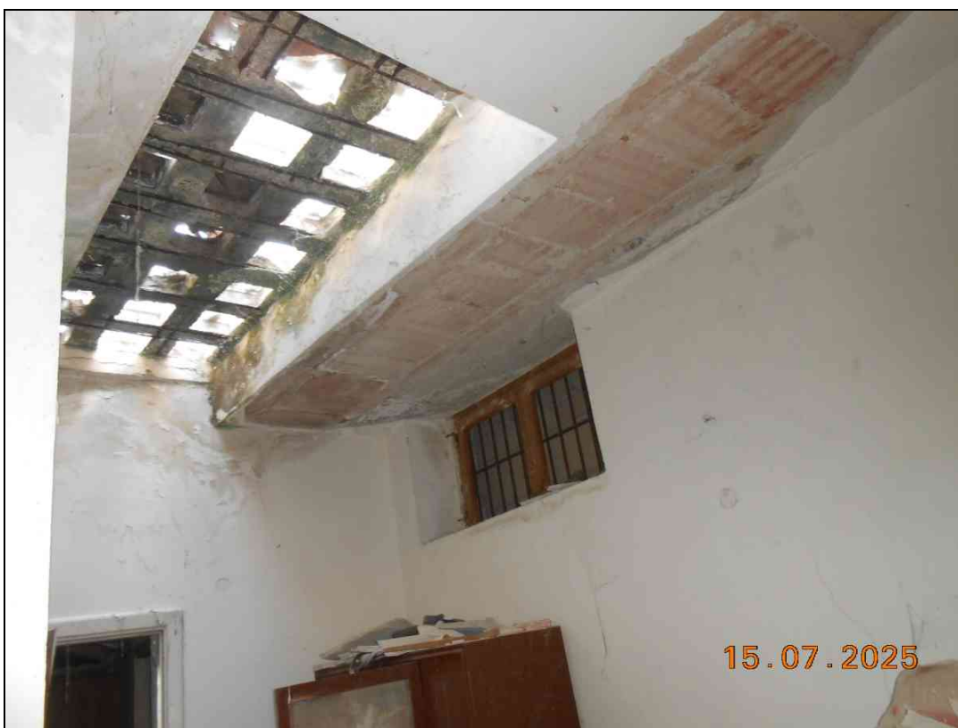
FOTO N. 32 Vista interna del piano primo. Si notano infiltrazioni dalla copertura piana.
