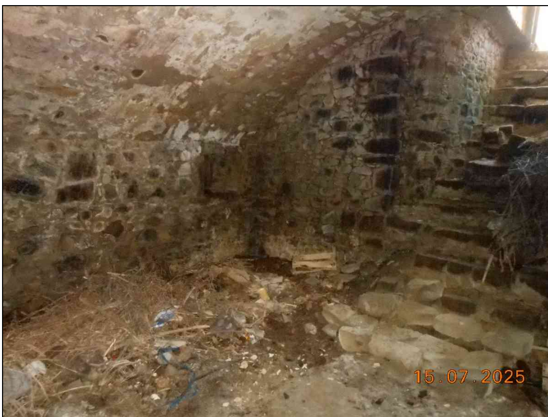
FOTO N. 10 Vista del locale al piano interrato. Si notano le precarie condizioni del locale.
