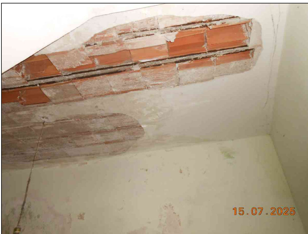
FOTO N. 16 Vista del solaio sfondellato.
