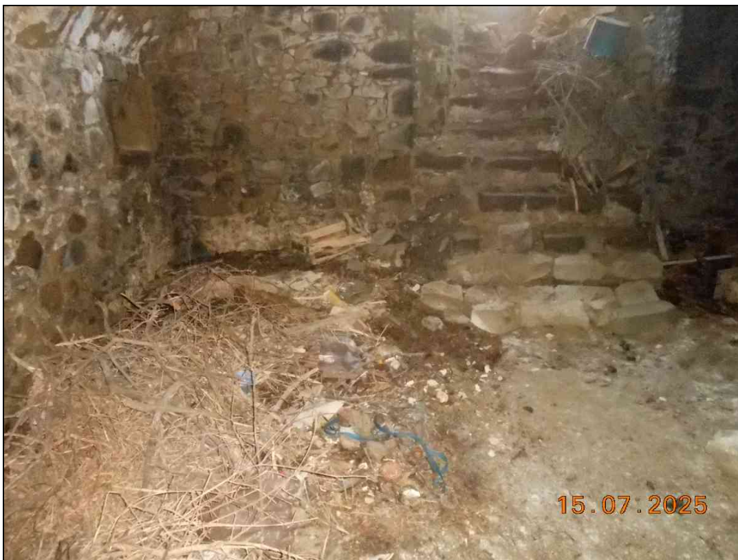
FOTO N. 09 Vista del locale al piano interrato. Si notano le precarie condizioni del locale.
