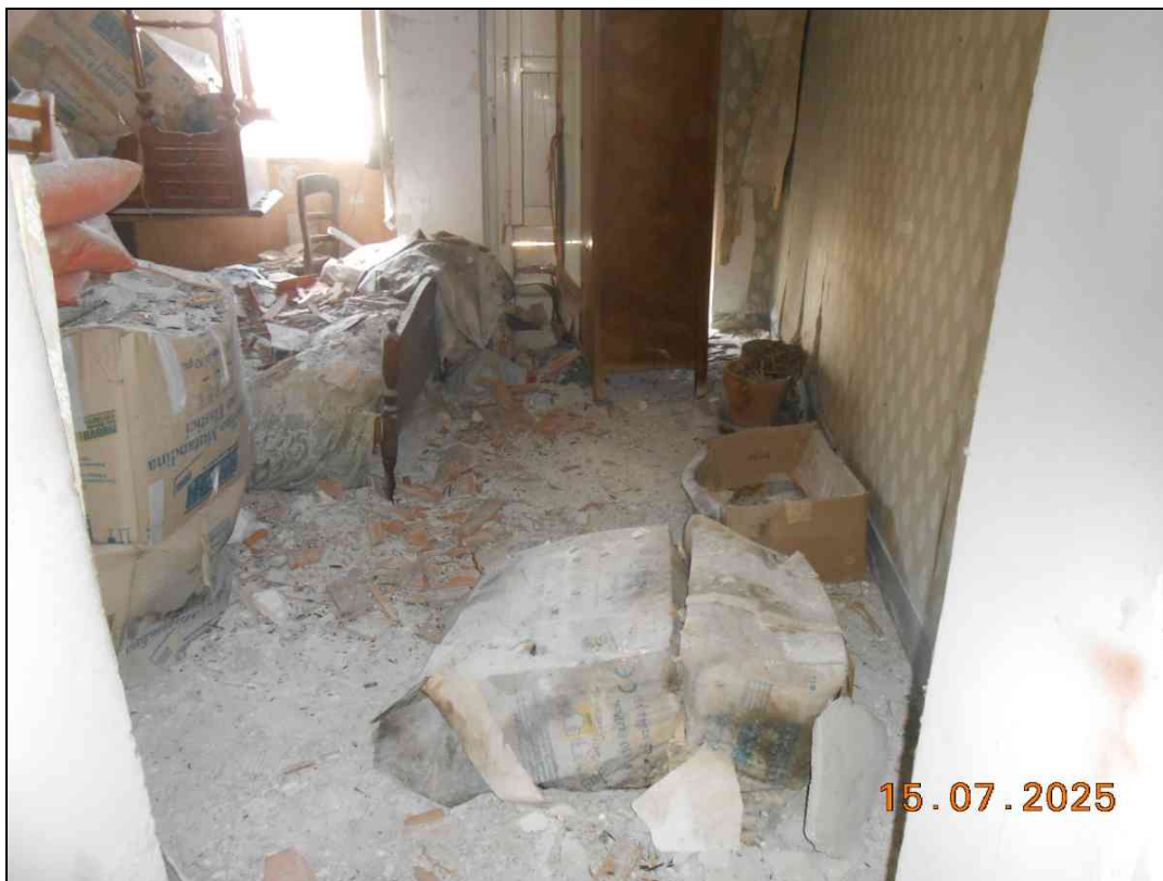
FOTO N. 27 Vista interna piano primo dell'immobile. Si notano calcinacci staccati dal soffitto, più rifiuti e arredi devastati.
