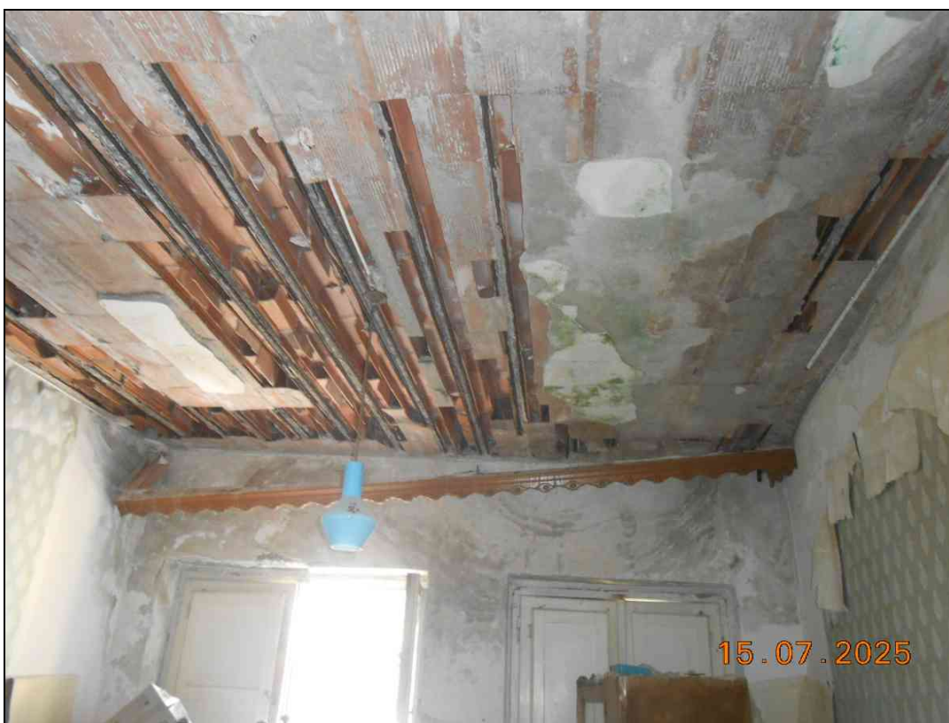
FOTO N. 28 Vista interna piano primo dell'immobile. Si nota il soffitto sfondellato a causa delle infiltrazioni meteoriche.
