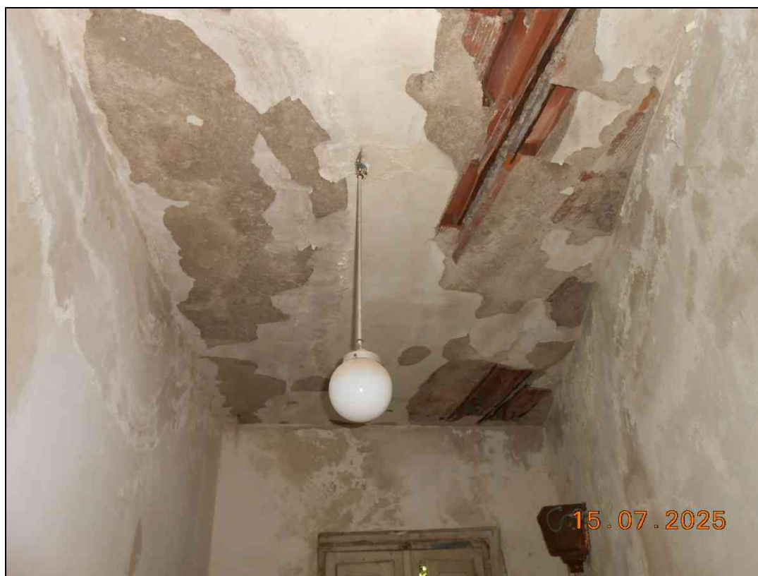
FOTO N. 36 Vista interna del piano primo dell'immobile. Si notano diffuse infiltrazioni meteoriche sul soffitto.
