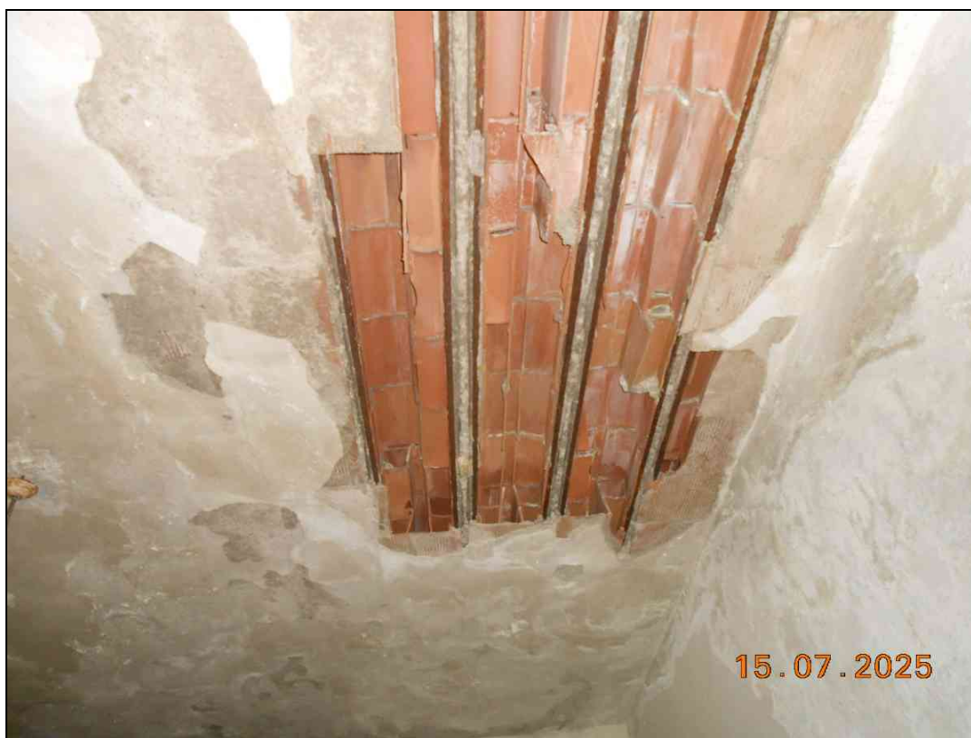
FOTO N. 38 Vista interna del piano primo dell'immobile. Si nota lo sfondellamento del soffitto.
