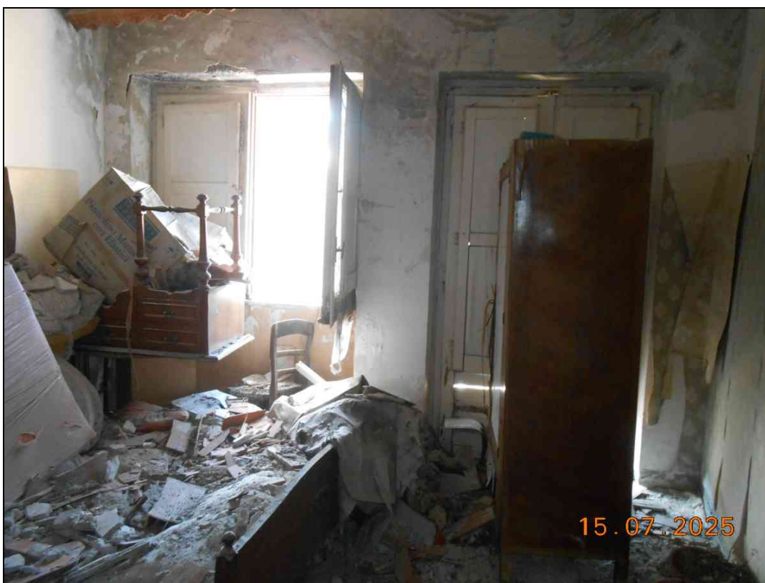
FOTO N. 30 Vista interna piano primo dell'immobile. Si nota il degrado statico dell'immobile.
