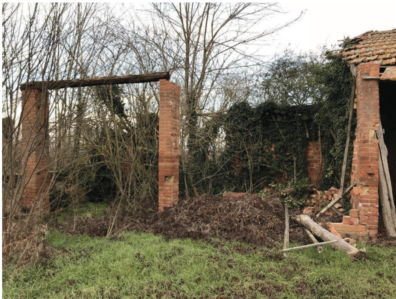
FOTO 31 - SCORCIO DELLA PARTE CROLLATA DELL'ANNESSO 3
