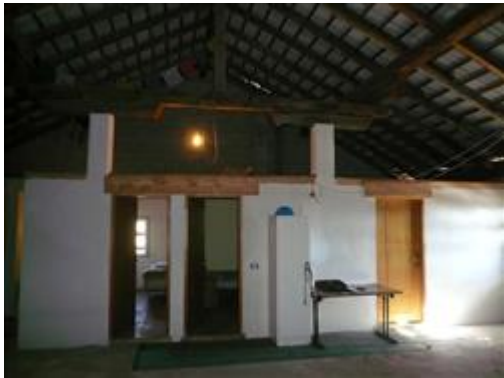
Piano primo: deposito agricolo con locali non autorizzati
