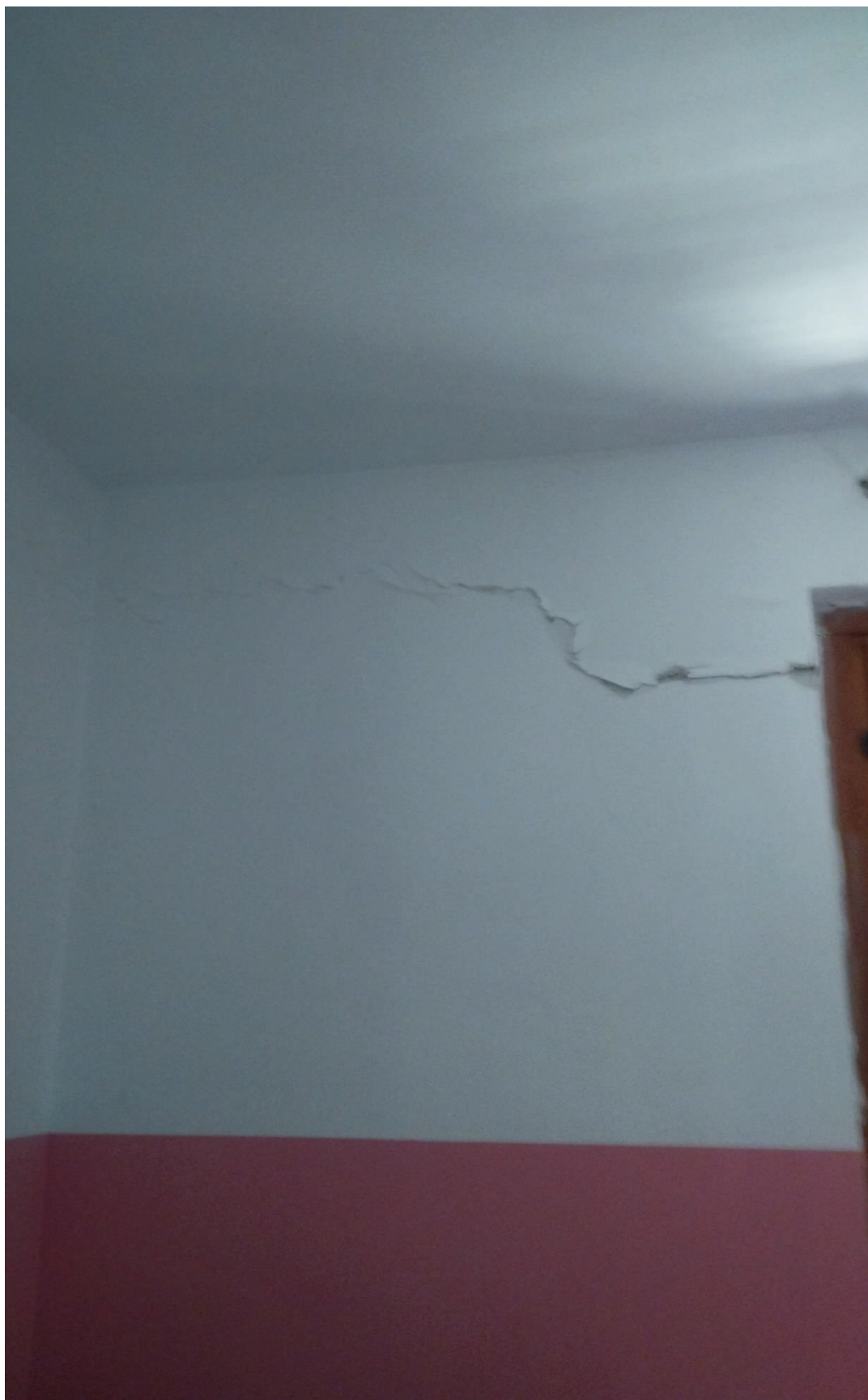
FOTO 16 – LESIONI MURO INTERNO
