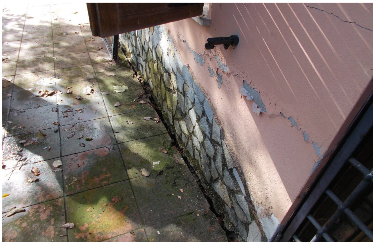
FOTO 8 – DISTACCO DEL MARCIAPIEDE DALLA PARETE
