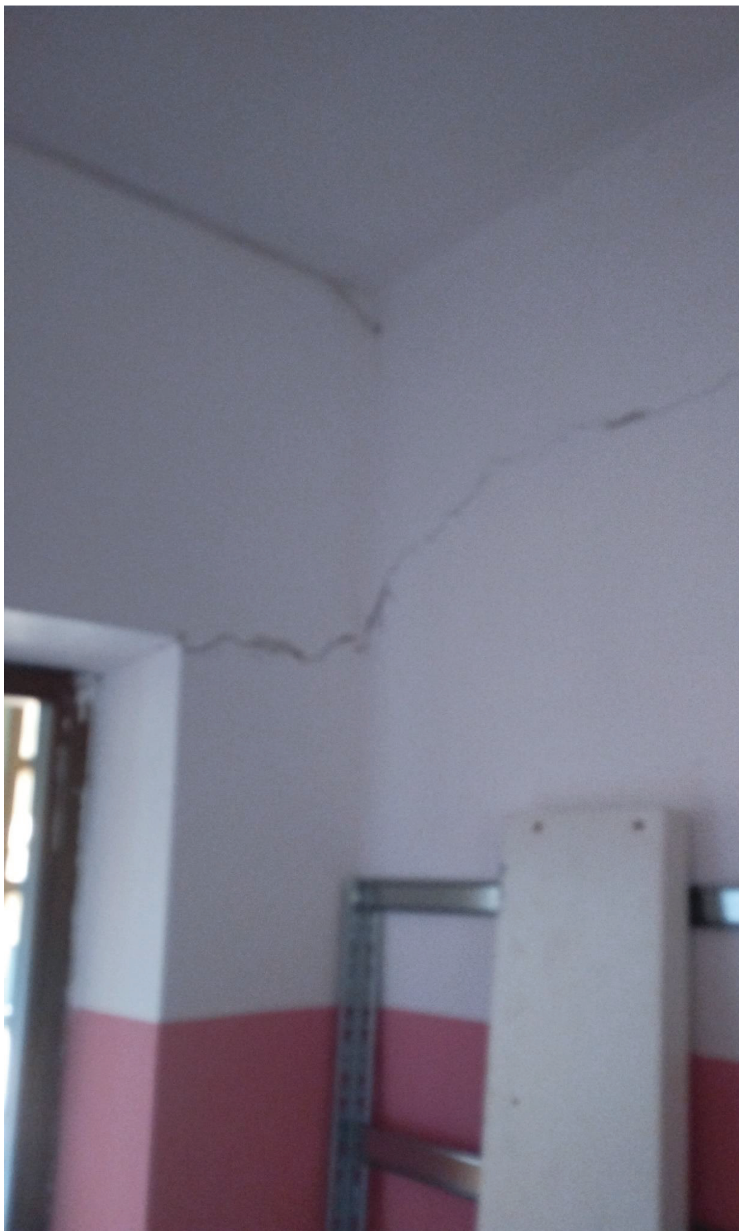
FOTO 17 – LESIONI MURO INTERNO
