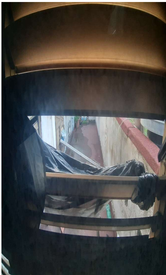
[Foto 37 – Balcone con infiltrazioni]
