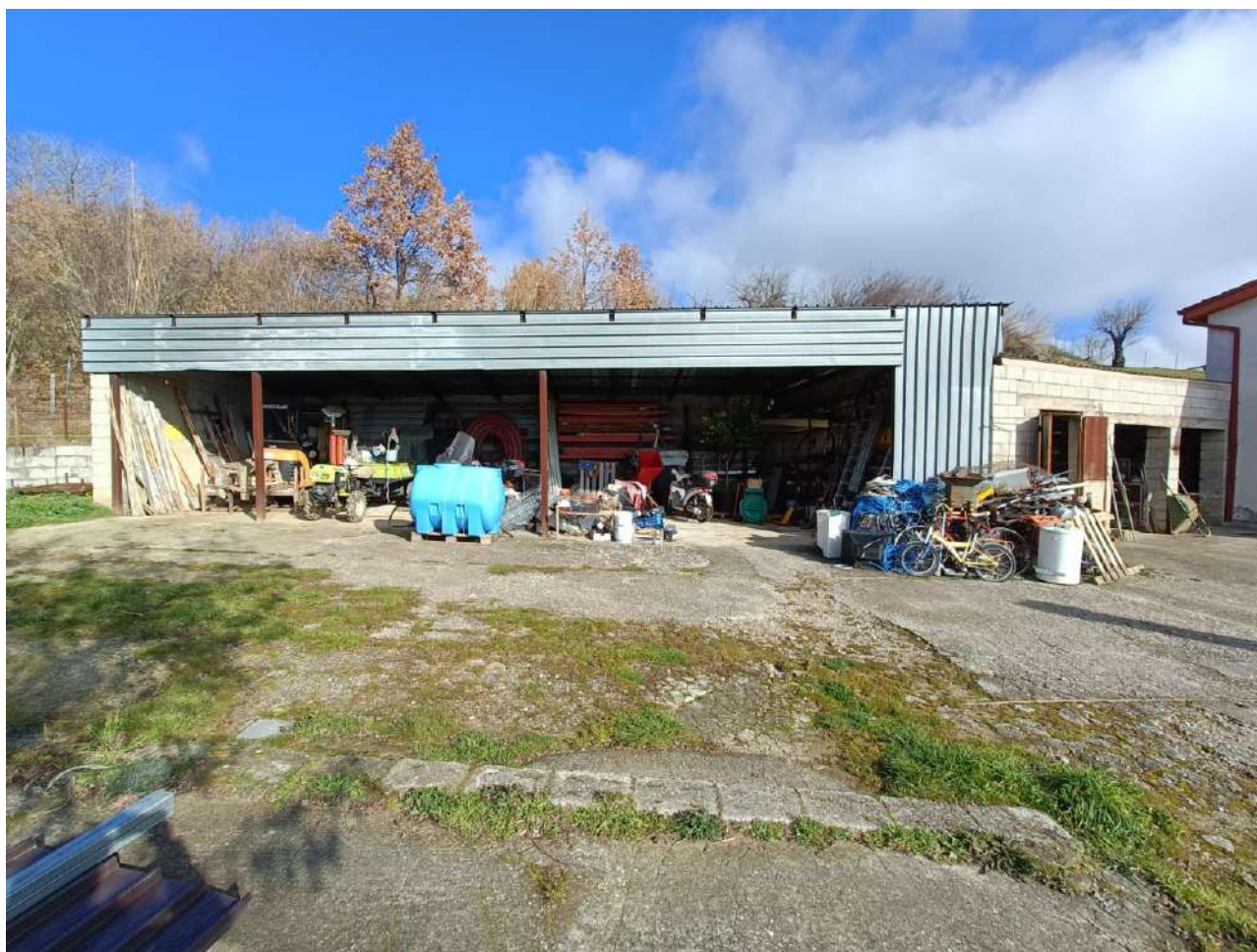
Figura 26 – Corpi di fabbrica realizzati in assenza di Titolo Abilitativo e non presente in Catasto.
