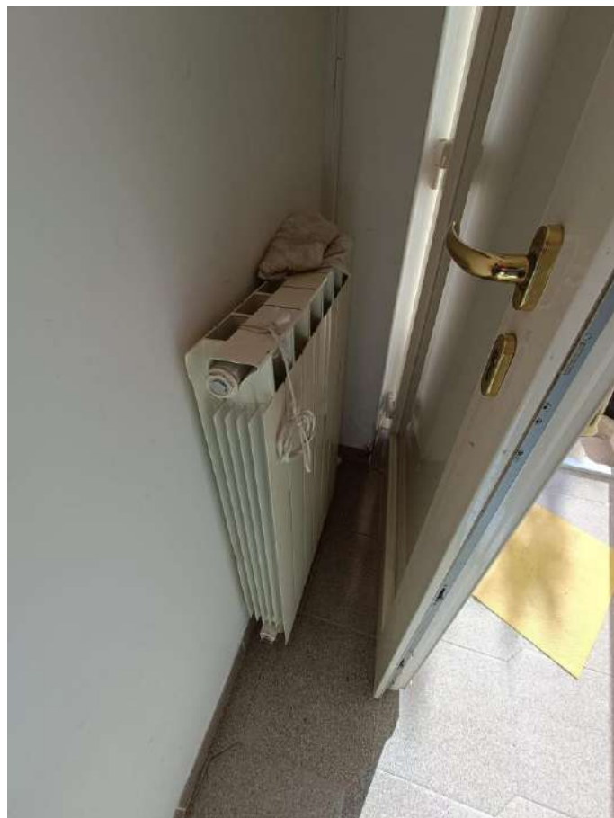
Figura 14 – Particolare Radiatori Piano Terra.
