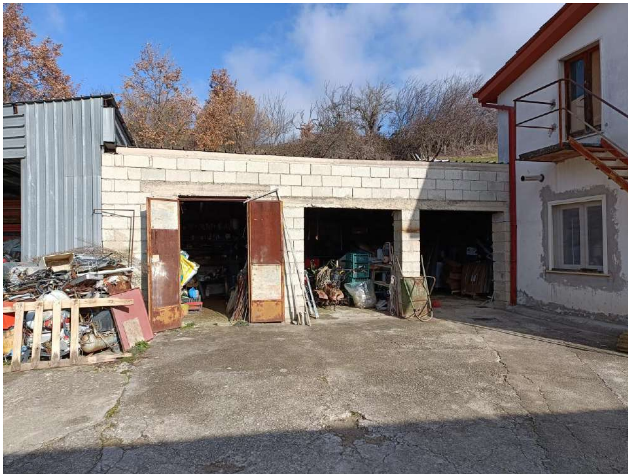
Figura 25 – Corpi di fabbrica realizzati in assenza di Titolo Abilitativo e non presente in Catasto.
