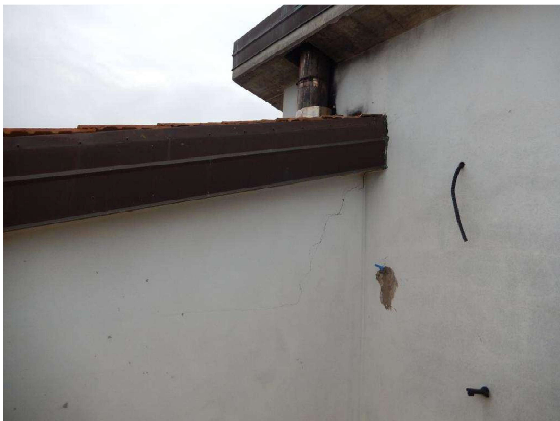
PARTICOLARE CREPE E FESSURAZIONI IN MURATURE PORTANTI
