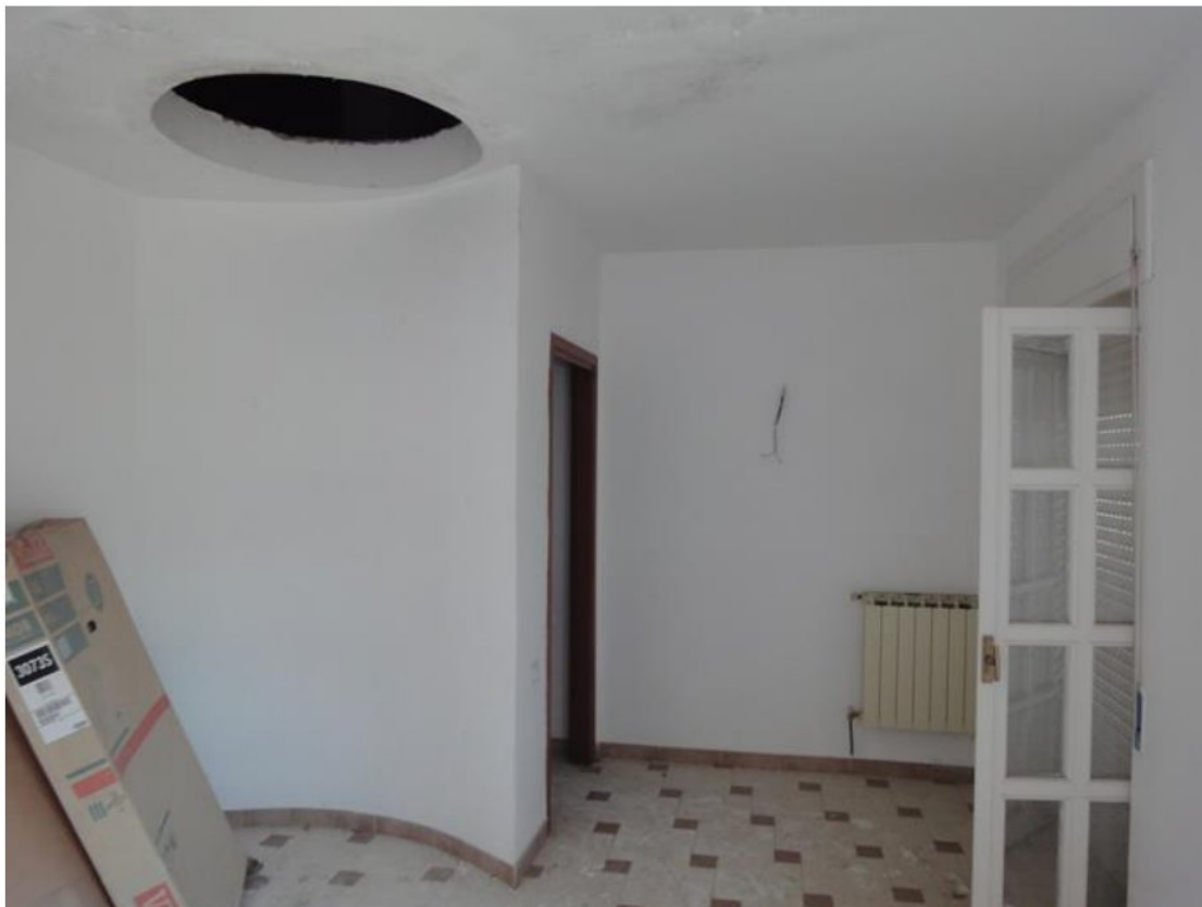
FOTO 44- LOTTO 3- ABITAZIONE in NCEU FL 16, P. LLA 299, SUB 24 PIANO TERZO- INGRESSO/SOGGIORNO, DETTAGLIO FORO SOLAIO DI ACCESSO AL SOTTOTETTO
