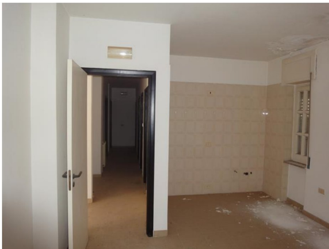
FOTO 29- LOTTO 2- ABITAZIONE in NCEU FL 16, P. LLA 299, SUB 8 PIANO TERZO- CUCINA+ DISIMPEGNO/CORRIDOIO
