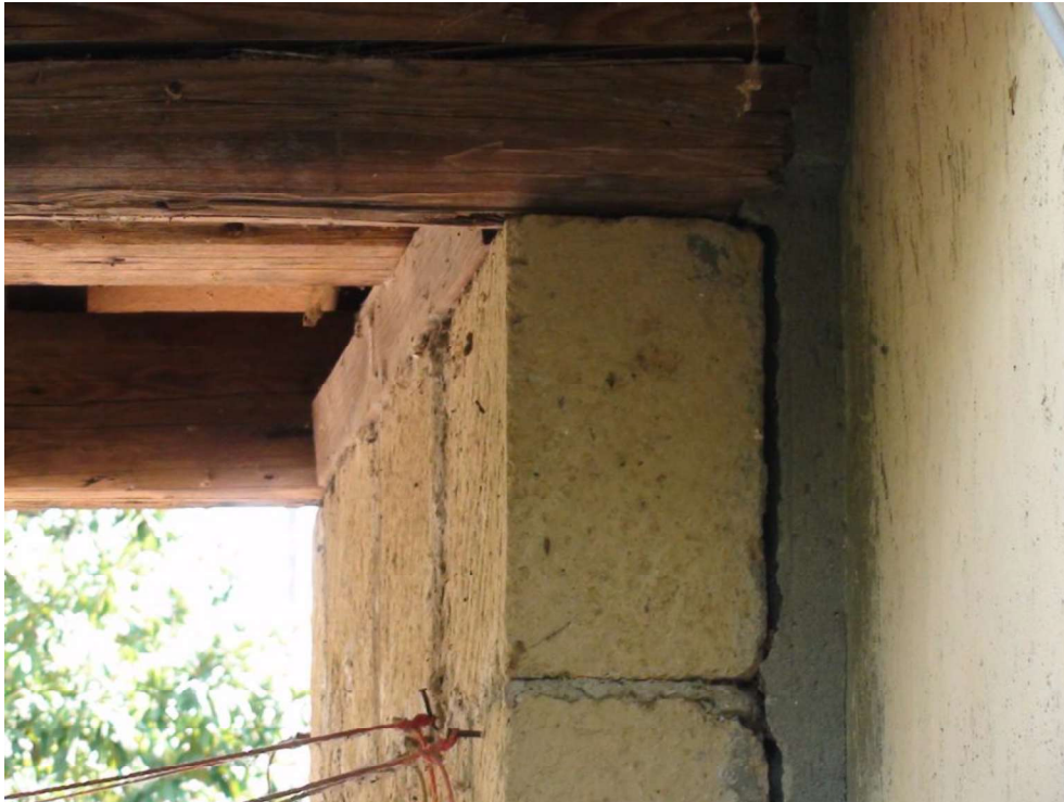
Figura 13 distacco causato dal cedimento del terreno sottostante la lavanderia
