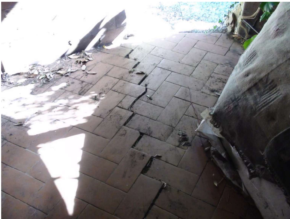
Figura 5 lesione del pavimento
