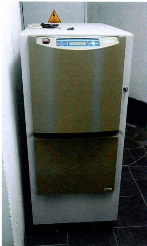
Foto 35 - Rif. 151 - gruppo continuità LIEBERT 11kw
