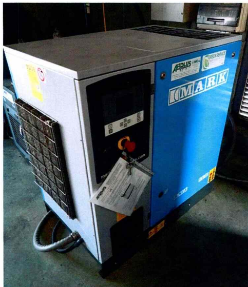
Foto 28 - Rif. 145 - COMPRESSORE MARK RMA 11 IVR
