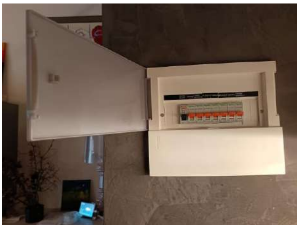
Quadro elettrico cucina con salvavita
