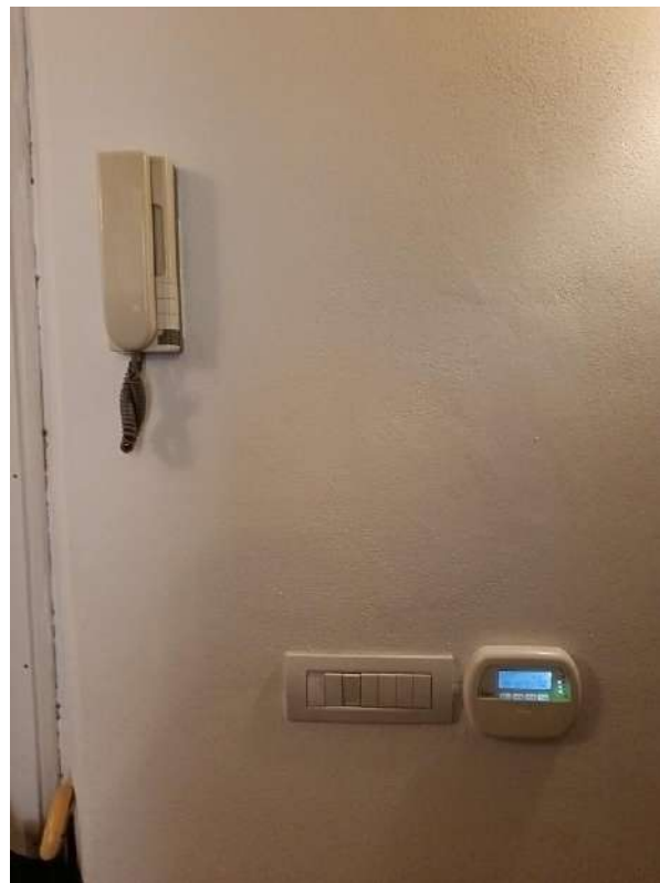
Citofono, allarme e placca con interruttori
