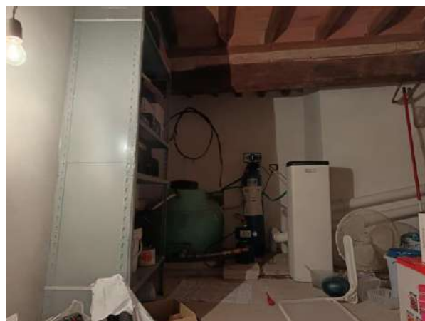
Impianto di addolcimento acqua, serbatoio pompa e press-controllo
