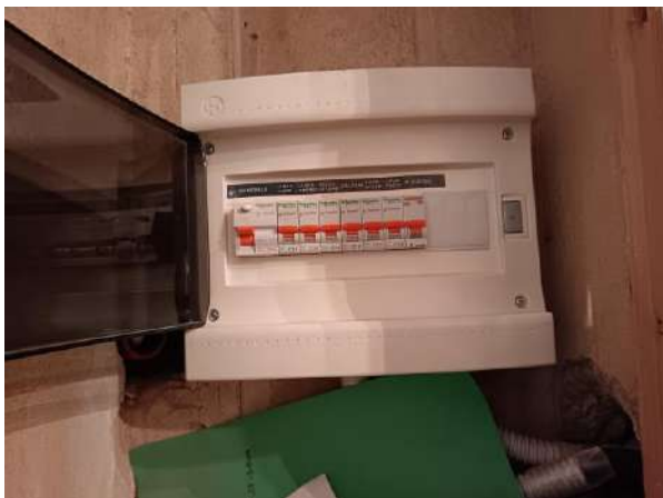
Quadro elettrico generale con salvavita
