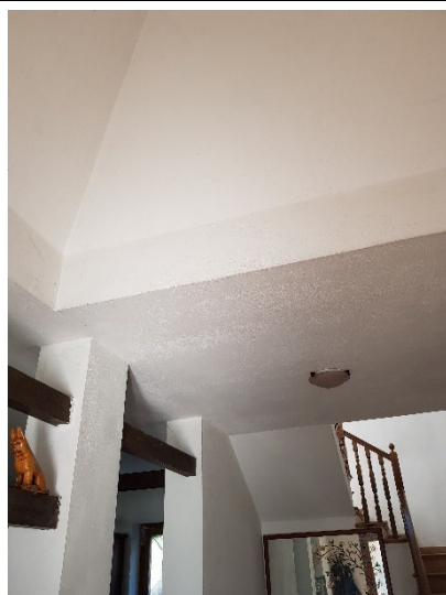
Foto 7 Particolate soffitto Ingresso
