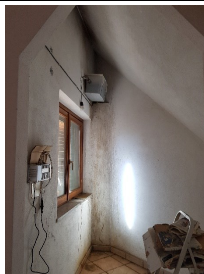
Foto 40 Partic. Quadro impianto FV
