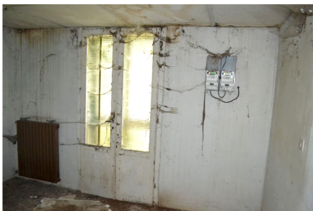
foto 1 - i due contatori elettrici nell'ingresso frontale, forse divisi tra unità abitativa e accessori sul retro, oltre a non essere evidentemente ispezionabili dalla strada sono in avaria totale da epoca non meglio precisata. Impossibile leggere il codice utente da display. Controsoffittatura calata a filo bi battuta della porta d'accesso. Locale abbandonato e invaso dalla sporcizia, come gli altri
