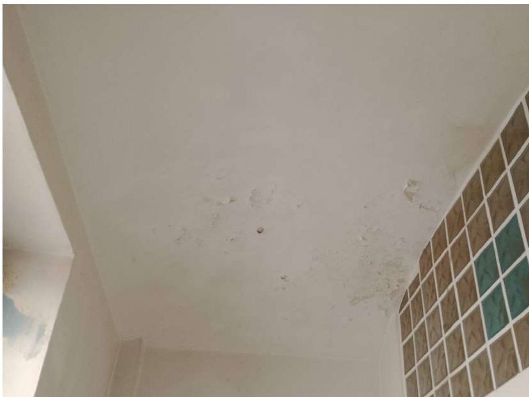
Foto n. 11: soffitto bagno interessato da infiltrazioni
