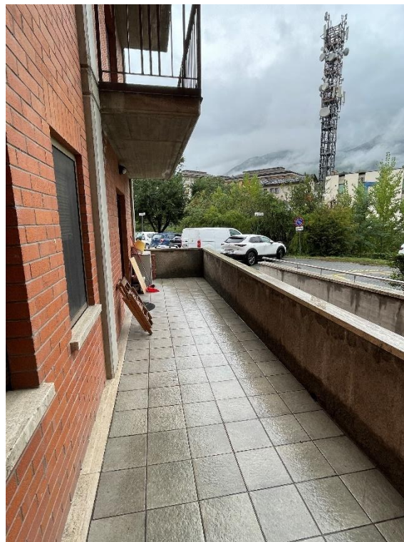
RIPRESA FOTOGRAFICA EFFETTUATA DAL C.T.U. – BALCONE – SUB. 3
