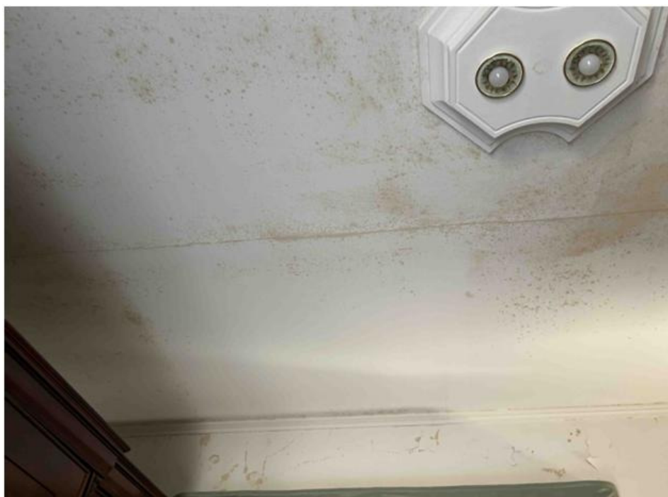
Foto n° 39 – Foto scattata al controsoffitto della camera da letto. Si rilevano tracce diffuse di condensa sia sul soffitto che nella parete prospiciente la via Principessa di Piemonte. E' visibile un corpo illuminante con tubazione sottotraccia.
