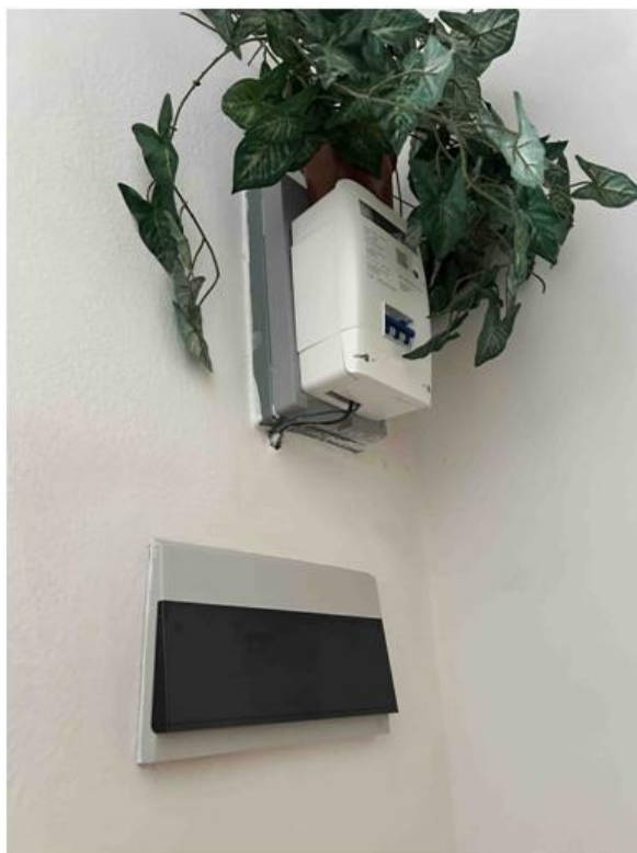
Foto n° 18 – Foto scattata al quadro elettrico generale posto all'ingresso del fabbricato, dotato di dispositivo magneto-termico (salva-vita).
