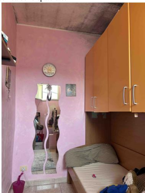
Foto n° 54 – Altra foto scattata alle pareti del secondo piano. Le pareti sono intonacate, tinteggiate e rifinite con la tecnica dello spatolato mentre quella del soffitto è rifinita con idropittura. Si rilevano vistose e diffuse tracce di condensa.
