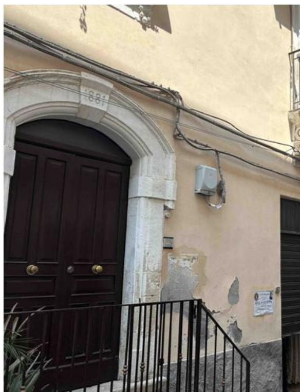
Foto n° 7 – Foto scattata al portone di ingresso ubicato in via Principessa di Piemonte n. 62. L'ingresso è rialzato rispetto alla sede stradale.
