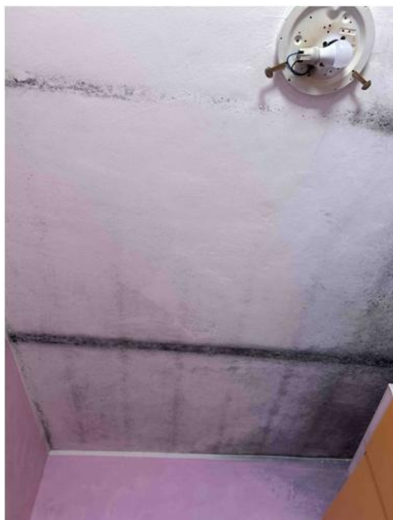
Foto n° 57 – Foto scattata al corpo illuminante posto nel secondo piano. Sul soffitto si rilevano vistose e diffuse tracce di condensa.
