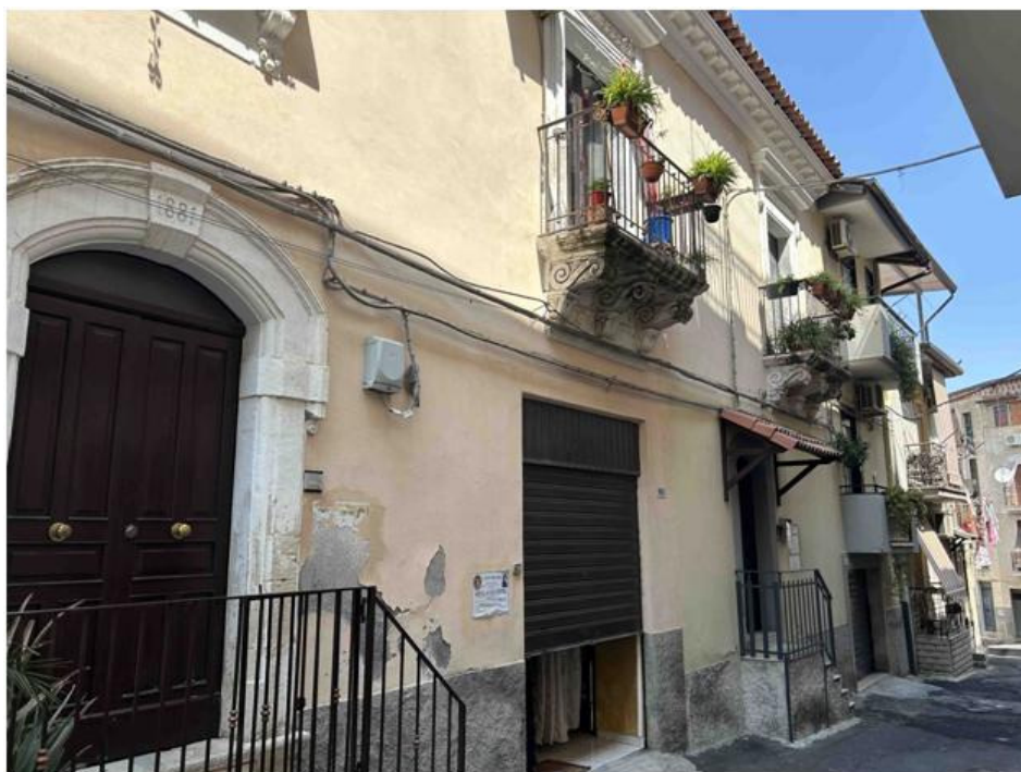
Foto n° 5 – Altra vista del prospetto principale su via Principessa di Piemonte. La facciata al piano terra presenta delle macchie di umidità. Buone le condizioni generali nel resto della facciata che risulta intonacata e ben rifinita.
