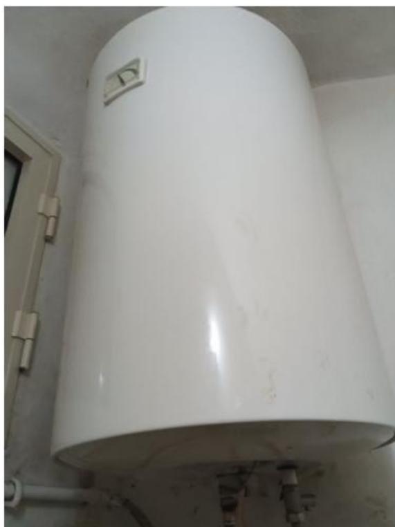
Foto n° 47 – Foto scattata allo scaldabagno da 80 litri ubicato nel locale sottostante.
