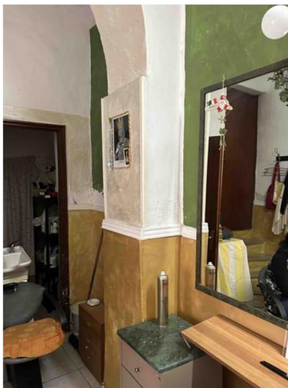
Foto n° 11 – Foto scattata all'interno del vano al piano terra. Le pareti sono intonacate e tinteggiate con due tecniche e colorazioni differenti, spatolato fino all'altezza di 1,00 metro ed idropittura nella parte superiore. Si rilevano tracce di umidità nelle pareti perimetrali.
