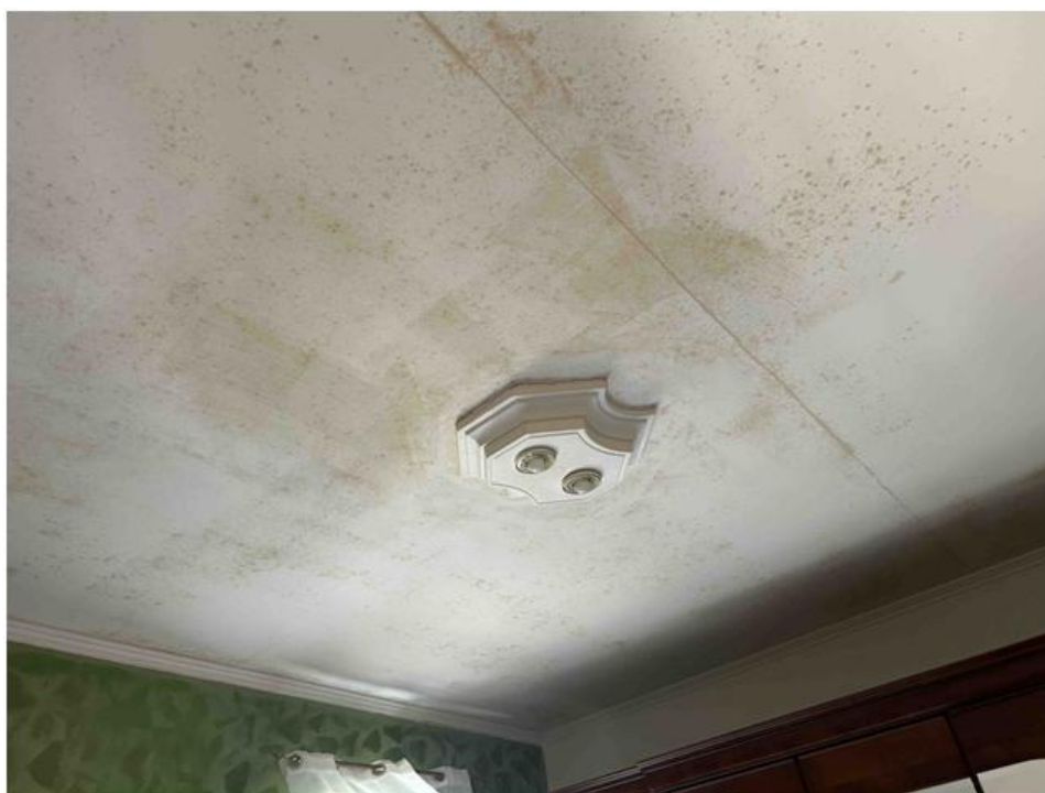
Foto n° 40 – Altra foto scattata al controsoffitto della camera da letto. Si rilevano tracce diffuse di condensa sia sul soffitto che nella parete prospiciente la via Principessa di Piemonte.
