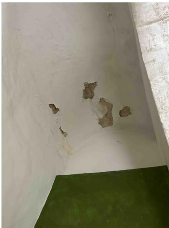
Foto n° 14 – Foto scattata al soffitto. Si rilevano infiltrazioni provenienti dal bagno del primo piano.
