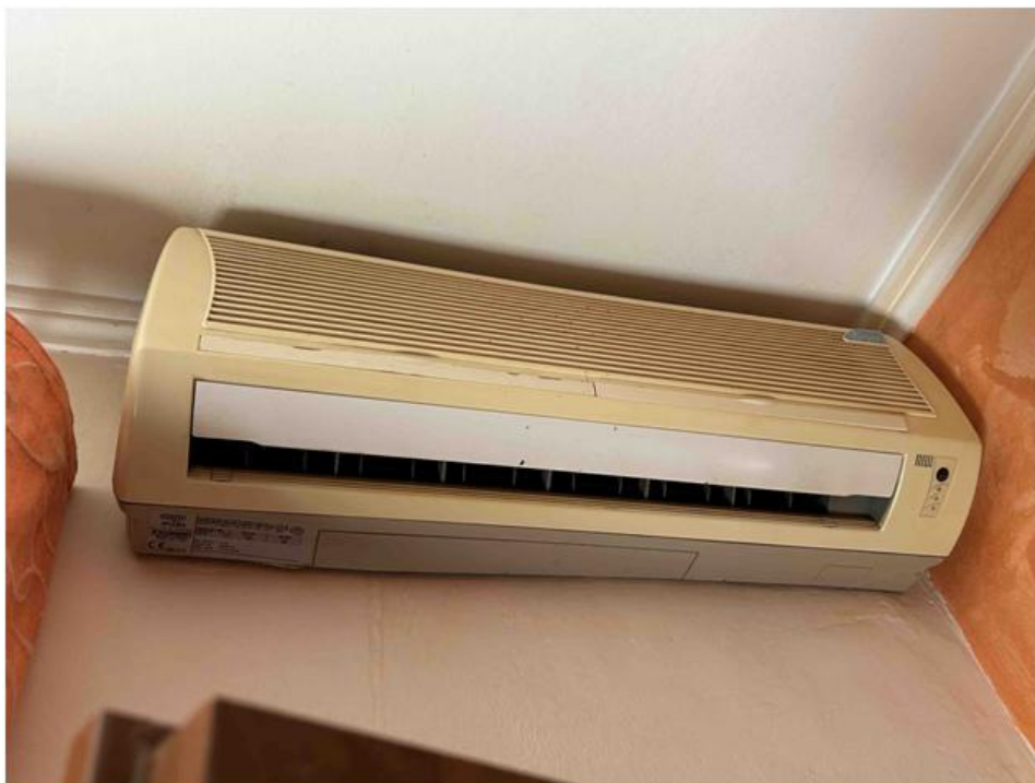
Foto n° 31 – Foto scattata al climatizzatore marca Argo installato nel vano cucina.
