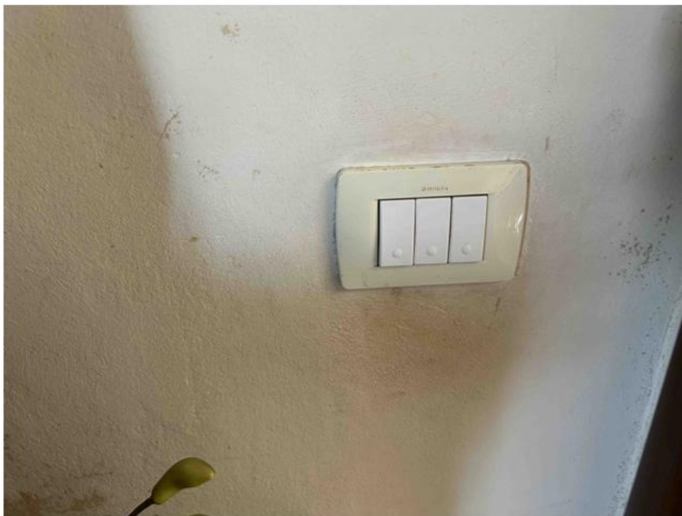
Foto n° 43 – Foto scattata all'interruttore del corpo illuminante posto nella camera da letto. L'impianto è sottotraccia e risulta a norma con le vigenti norme in materia.
