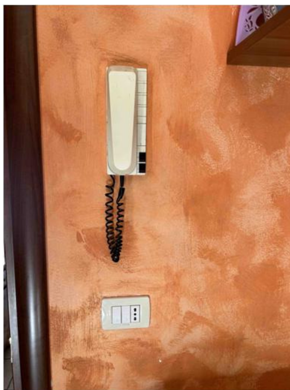
Foto n° 30 – Foto scattata ad uno degli interruttori elettrici del corpo illuminante della cucina ed al citofono interno. Buone le condizioni.
