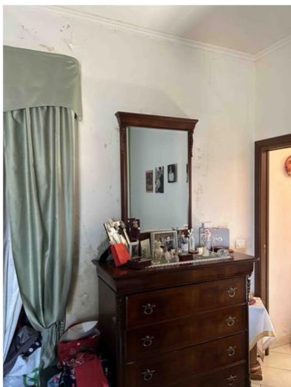
Foto n° 38 – Altra foto scattata nel vano adibito a camera. La parete è intonacata e rifinita con idropittura in cui è anche visibile della condensa. E’ presente un infisso a due ante in alluminio pre-verniciato che consente l’affaccio su via Principessa di Piemonte.
