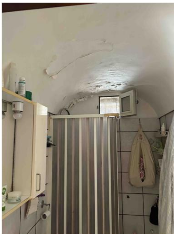
Foto n° 45 – Foto scattata nel bagno. E' presente un infisso di ridotte dimensioni che consente l'aerazione e l'illuminazione.
