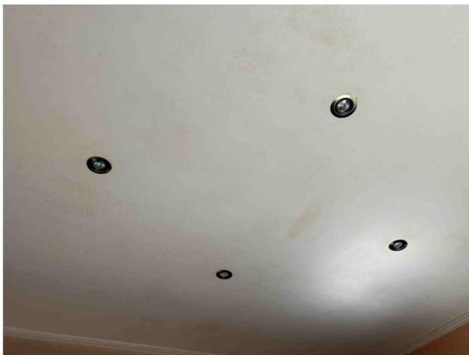
Foto n° 29 – Foto scattata al controsoffitto del vano cucina da cui si rilevano i faretti a led incassati (corpi illuminanti).
