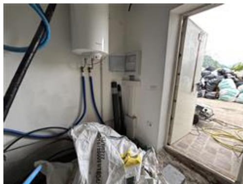
centrale termica - piano terra
